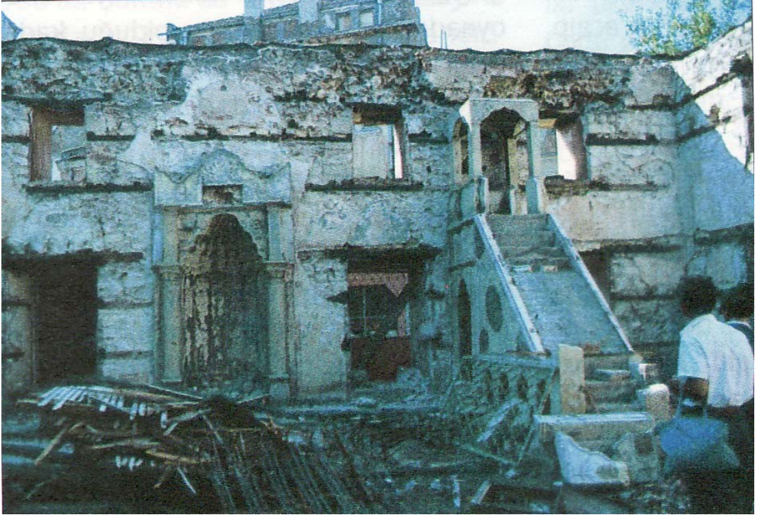
Resim: 24-Çarşı Camisi, 1960 yangını sonrası harim güney cephesi (S. Eyice'den)
