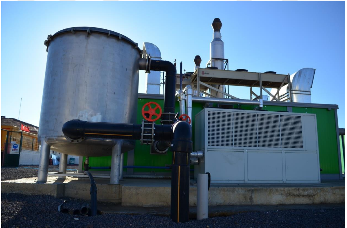
Şekil 5.46. Gaz Arındırma ve Soğutma Sisteminin Uygulamadaki hali
