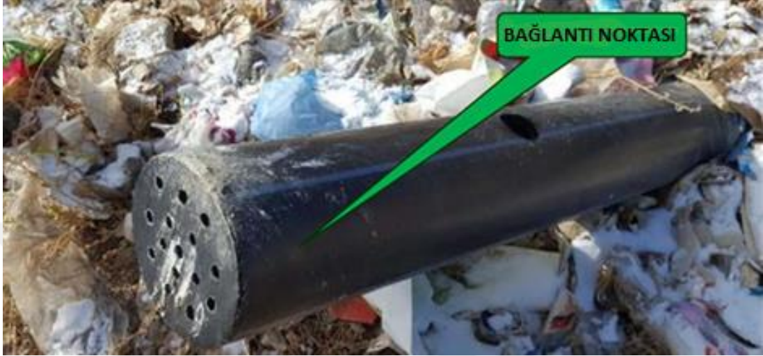
Şekil 5.21. Drenaj borularının gaz toplama sistemine bağlantı noktası (Seyfert ve Elfruth, 2017).
