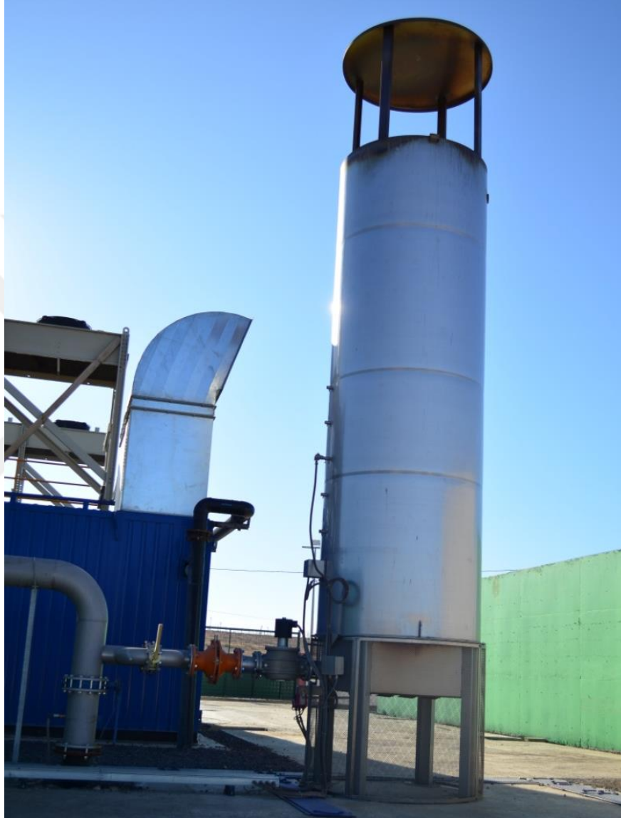
řekil 5.47. Yakma Bacası (Flare) Sistemi uygulamadaki hali
