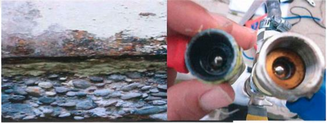
Şekil 5.44. Biyogazın gaz deposu ve bağlantı elemanlarında oluşturduğu korozyon
