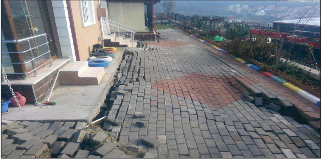
Şekil 5.6. Çevre yapılarında oluşan göçme, çatlak ve deformasyonlar
