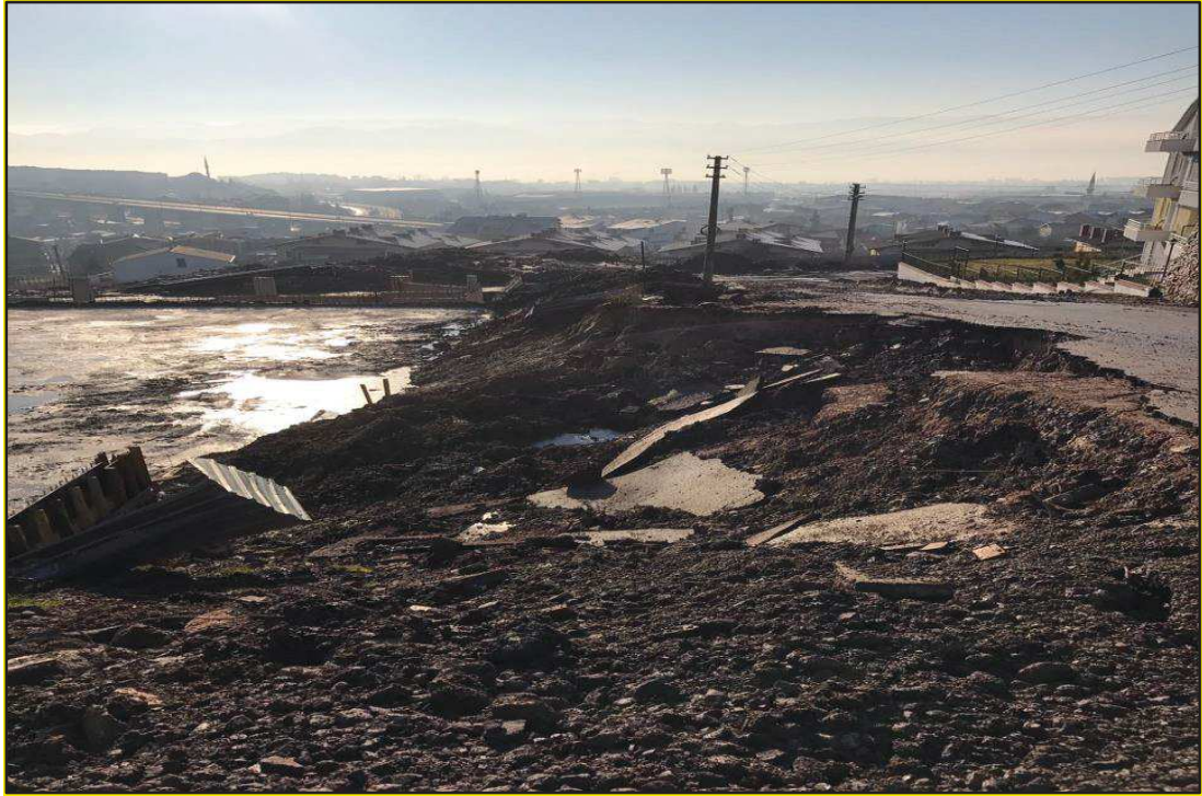
Şekil 5.3. Parselin batı cephesindeki yolda oluşan göçmeler
