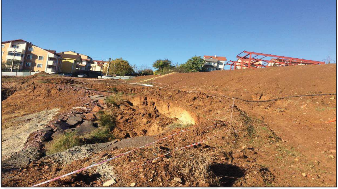
Şekil 5.4. Parselin kuzeydoğu cephesindeki yolda oluşan göçmeler
