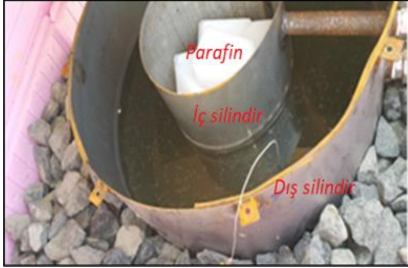
Şekil 4.6. Isı deposu içinde bulunan tank, üstten görünüş
