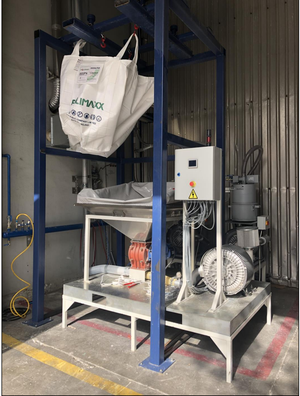
Şekil 2.30. Silo Dolum Ünitesi
