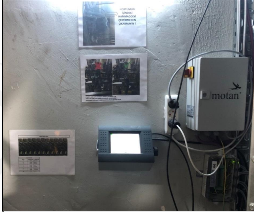
Şekil 2.37. PLC Merkez Kontrol Ünitesi
