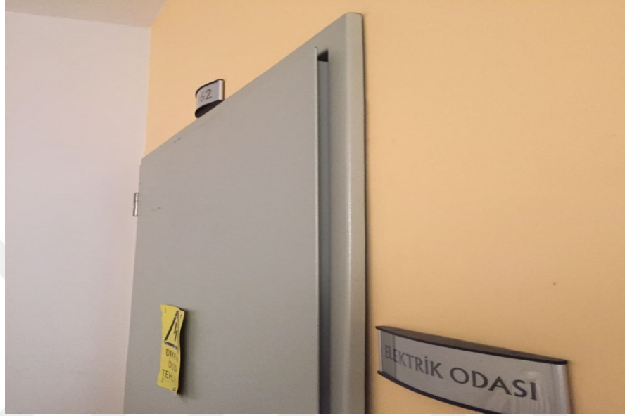
Şekil 4.21. Tam kapanmamış elektrik odası kapısı.
