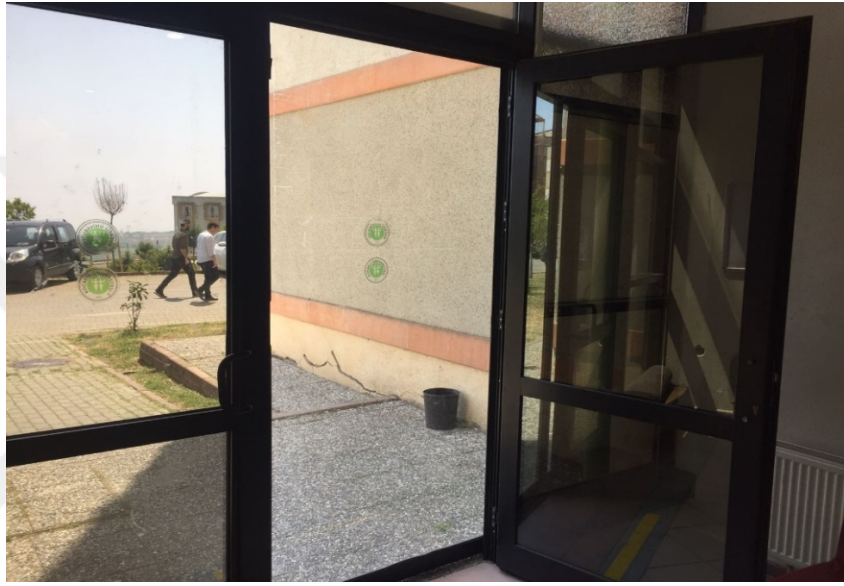
Şekil 4.8. Mühendislik Fakültesi bodrum kat acil tahliye kapısı.
