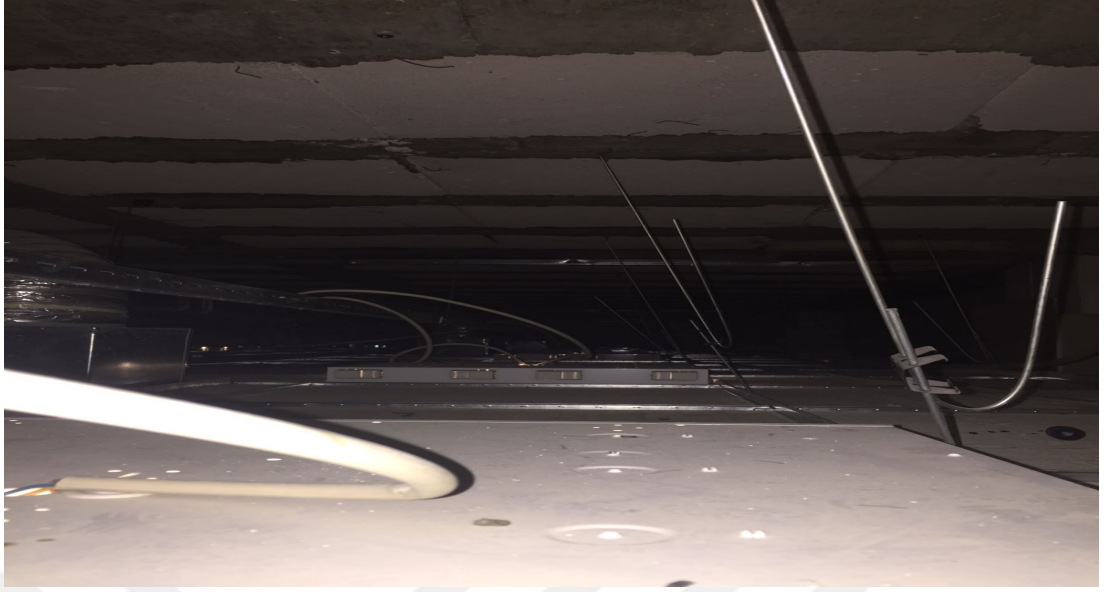
Şekil 4.23. Tavan arası kablo geçişleri .
