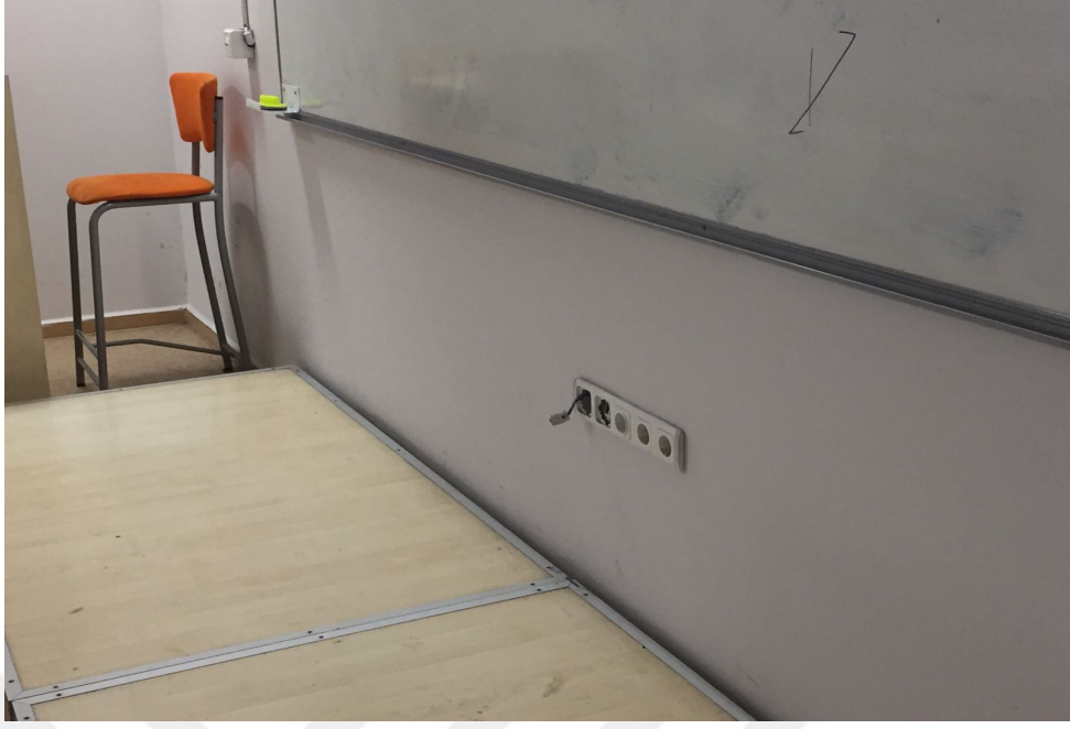
Şekil 4.19. Montajı yapılmamış priz ve açıkta duran kablolar.
