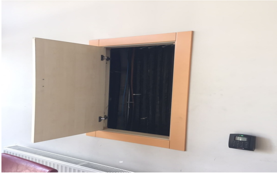
Şekil 4.20. Elektrik kablolarının geçtiği kısımda ahşap olan shaft kapağı.
