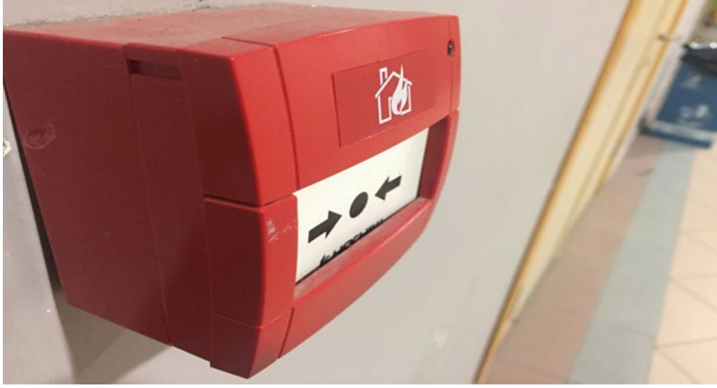
Şekil 4.12. Yangın uyarı butonu.
