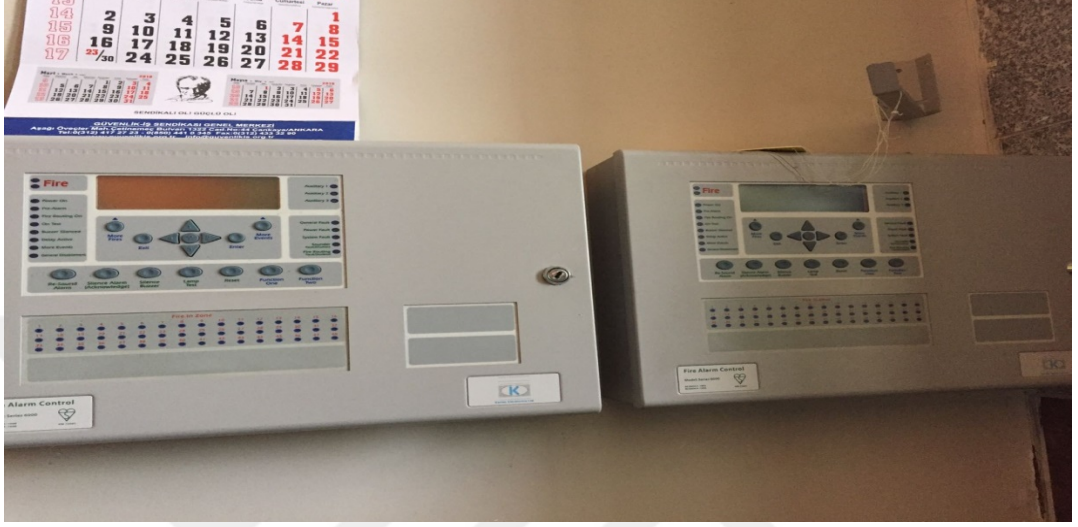
Şekil 4.16. Mühendislik Fakültesi B Bloкта çalışmayan yangın paneli.
