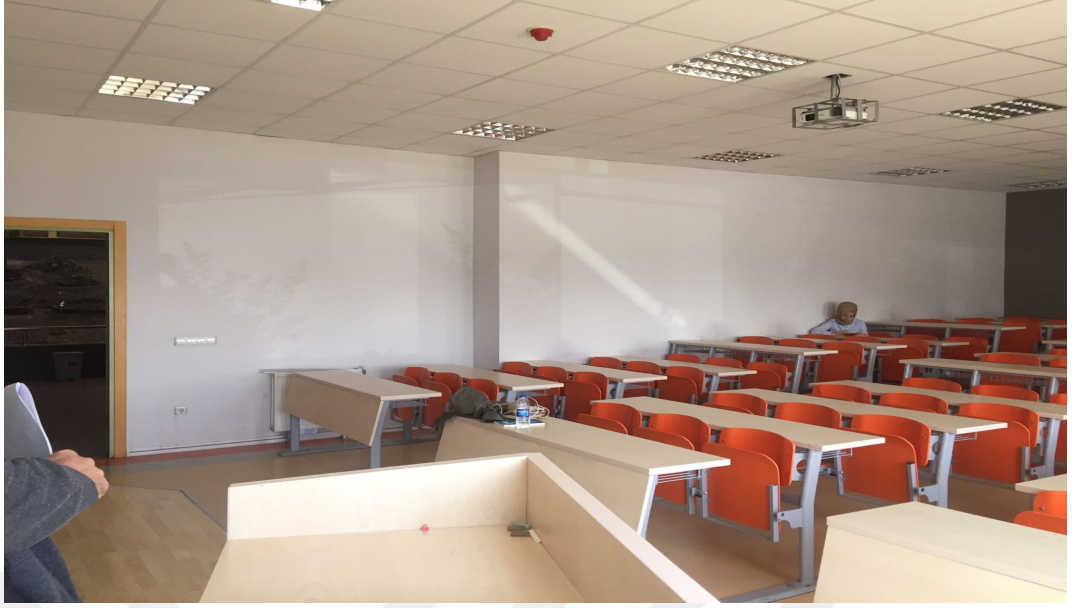
Şekil 4.13. İnşaat Mühendisliği Bölümü A4 sınıfında kapağı açılmayan duman dedektörü.
