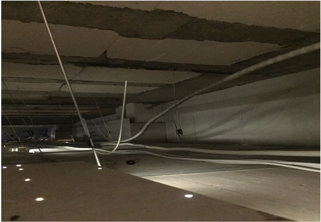
Şekil 4.24. Tavan arasında bulunan kablo geçişleri.
