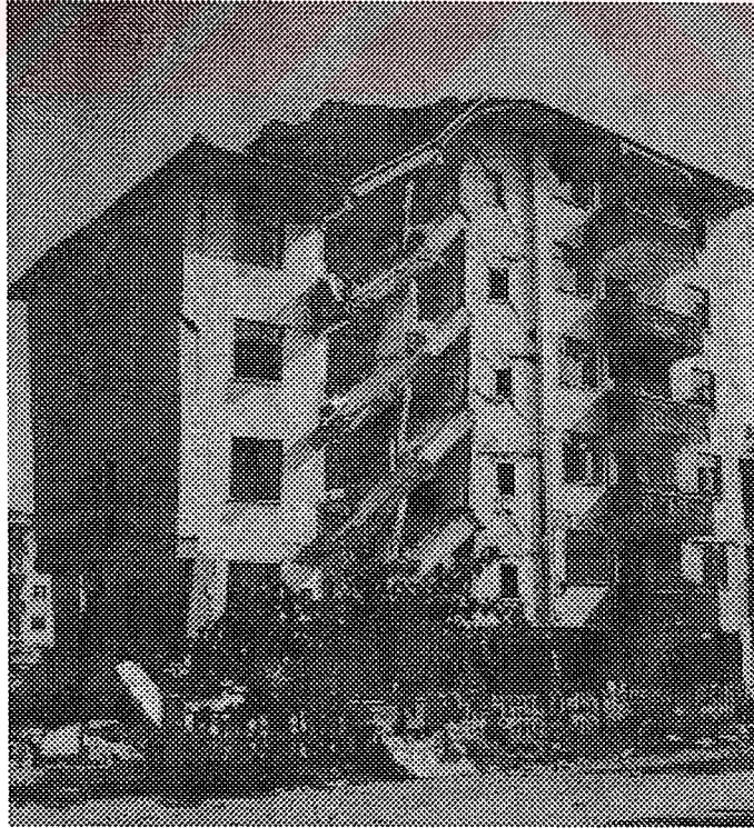
Şekil 6.8. Derz ile ayrılmayan yapıda meydana gelen hasar
