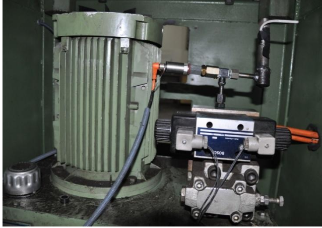
Şekil 4.16. Hidrolik pompaya baęlı basınç transmitteri ve basınç valfi
