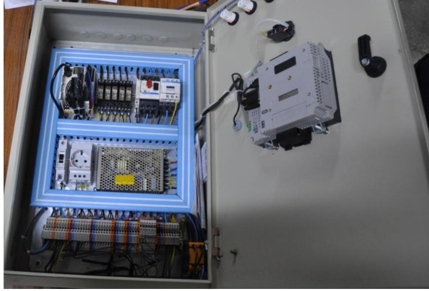
Şekil 4.21. Kontrol Panosu iç görünüm
