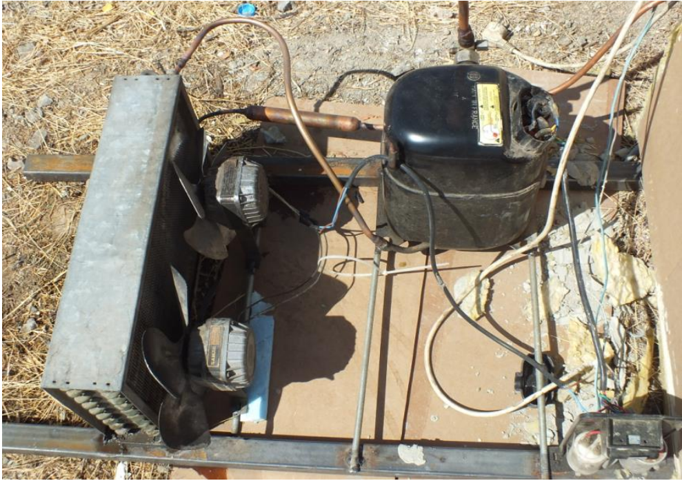
Şekil 2.6. Denev odasının soğutma sisteminin görünüşü
