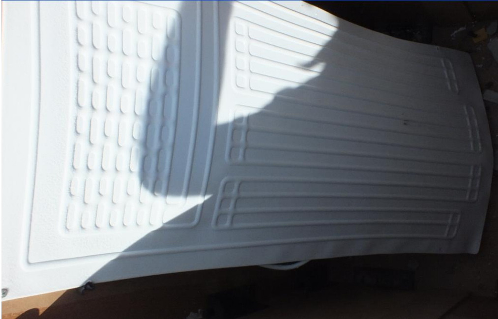
Şekil 2.8. Deney odasının içten görünüşü, soğutucu sistemi
