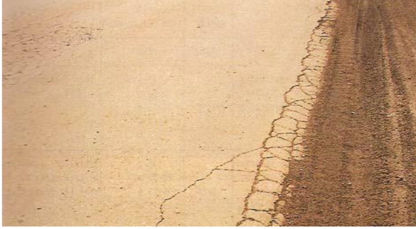
Şekil 3.22. Kenar çatlağı oluşumu
