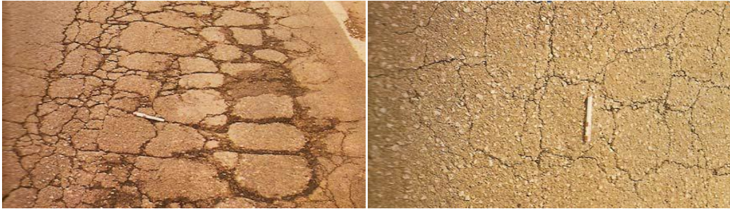
Şekil 3.21. Yüksek ve orta şiddetli yorulma çatlakları
