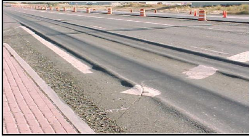
Şekil 3.17. Tekerlek izi oluşumu
