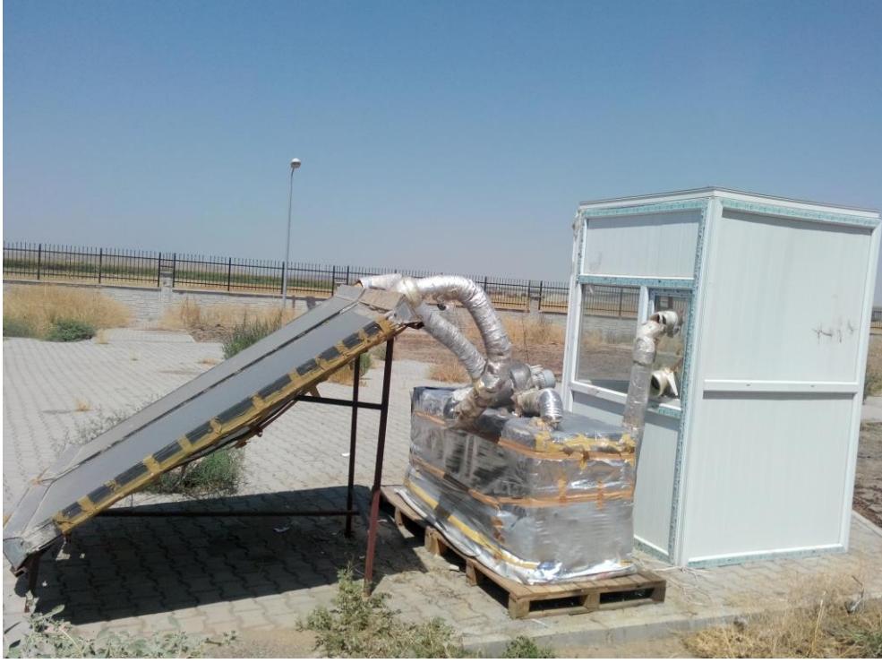
Şekil 7.1.b. Güneş enerjisi depolamalı ısıtma sisteminin genel görüntüsü
