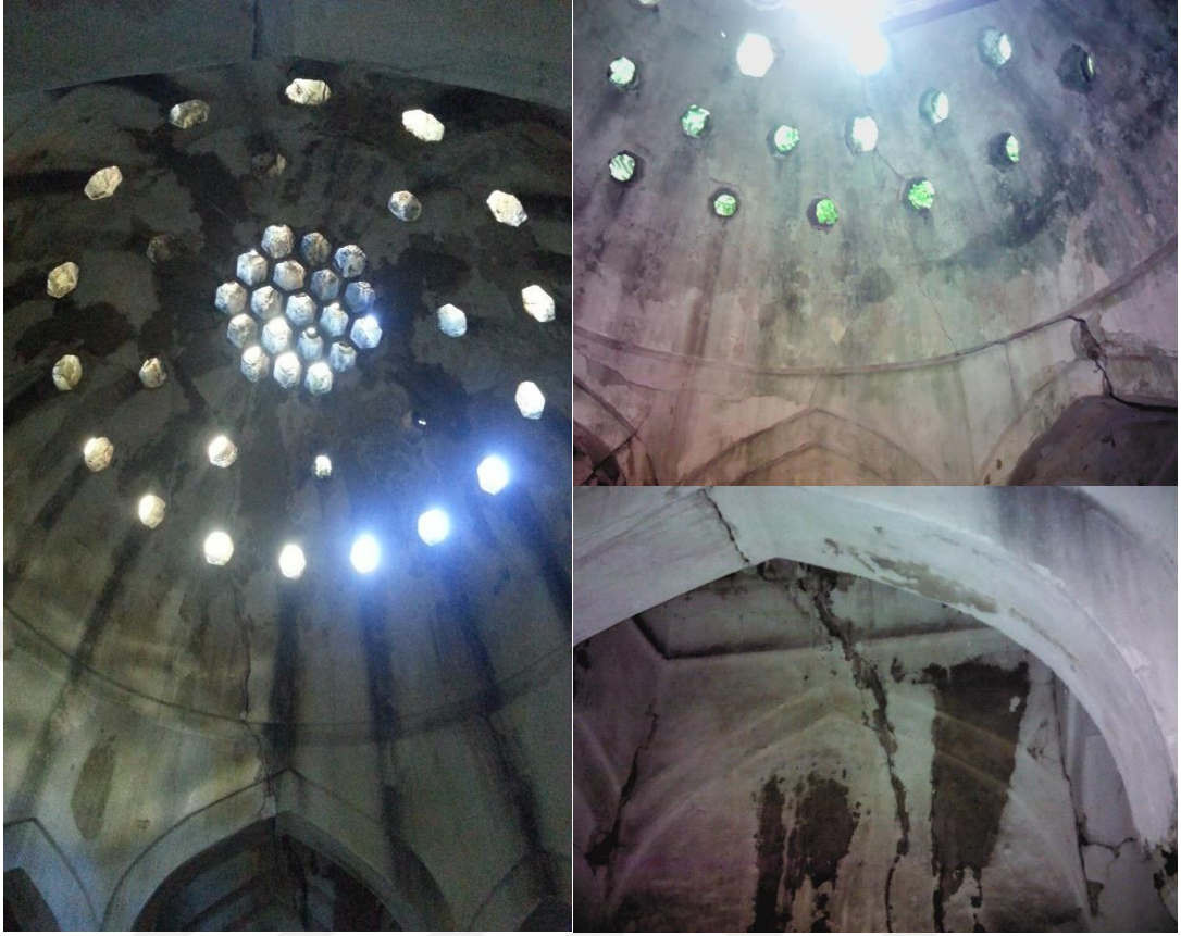
Şekil 4.20. Sıcaklık mekânı kubbesi ve yapısal çatlak (sol, sağ alt) Ilıklık mekânı
