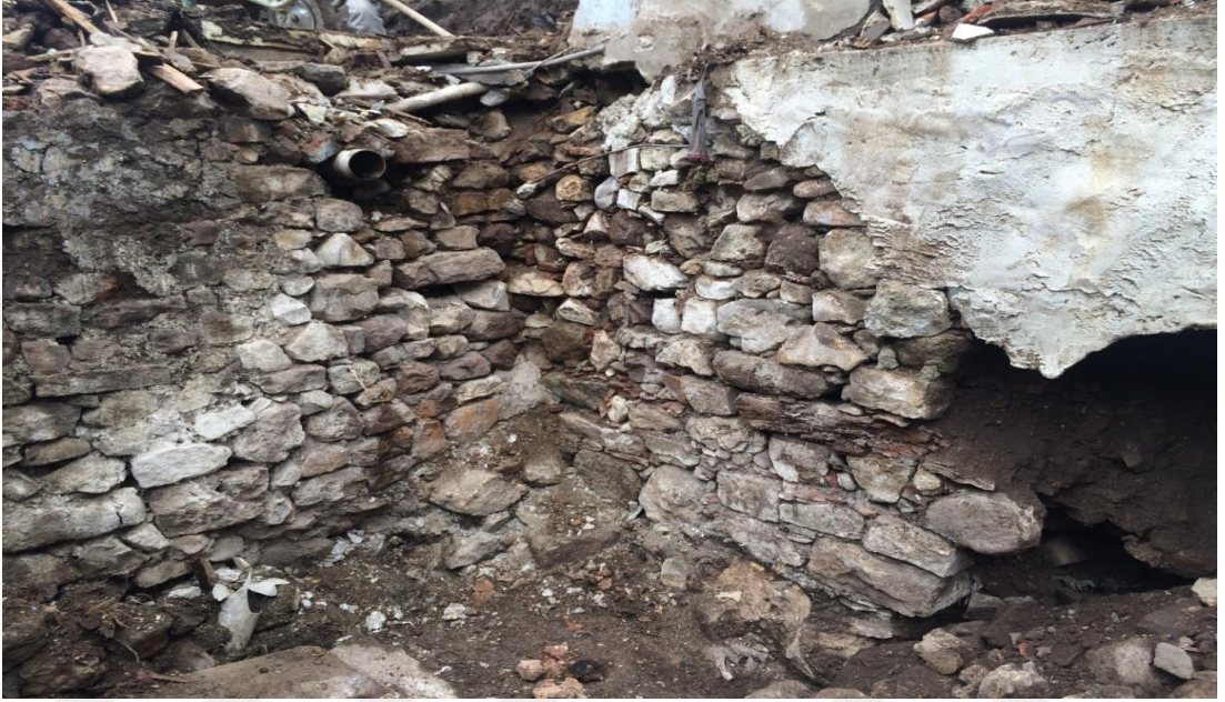
Şekil 4.11. Bodrum kat her ikisinin de arka yüzeyi toprak olan kuzey (soldaki) ve doğu (sağdaki) duvarının durumu
