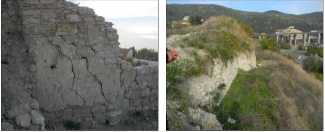
Şekil 4.46. Sur duvarları üzerinde bulunan çatlaklar ve bitkileşme
