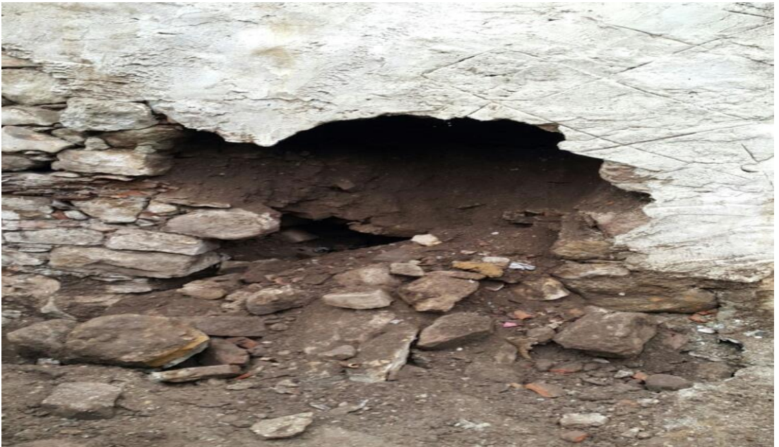
Şekil 4.12. Doğu duvarında açılan muayene çukuru sonrası kısmi çökme oluşumu
