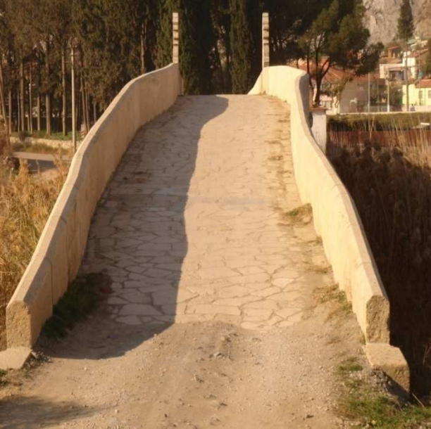
Şekil 4.24. Tarihi köprü üzerindeki sağ yanal olarak gözlenen deformasyon.
