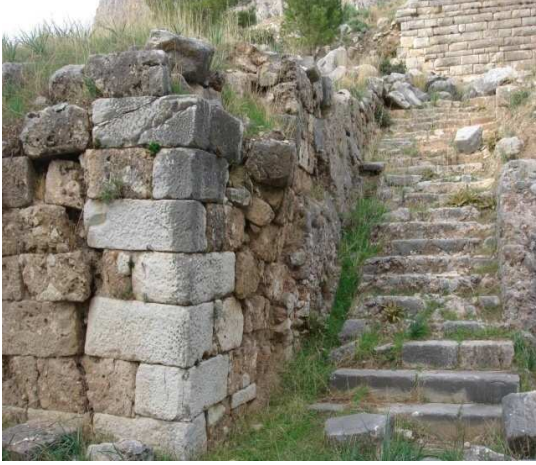
Şekil 4.20. Kutsal salonun (Sacret stoa) batısındaki bir duvarda gözlenen deformasyon. Duvarın hemen doğusundaki basamaklar tamamen fay bireşi içine oyularak inşa edilmiştir.
