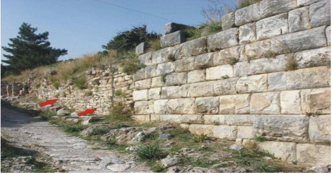
Şekil 4.13. Antik kentin doğu girişinde bulunan D-B doğrultulu duvar üzerinde gözlenen tadilat izi. Duvar üzerindeki farklı yapı elemanları tarafından inşaa edilmiş iki farklı bölüm olması, duvarın kırmızı oklarla gösterilen bölümünün yıkılmış olduğunu daha sonra farklı yapı elemanları kullanılarak tekrar yapıldığını göstermektedir.
