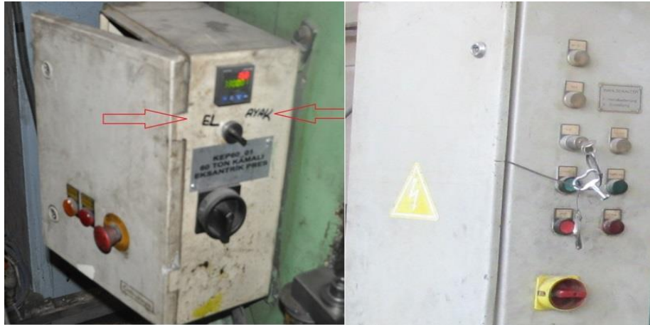
Şekil 4.5. Pres elektrik panolarının önceki (sol) ve sonraki (sağ) hali
