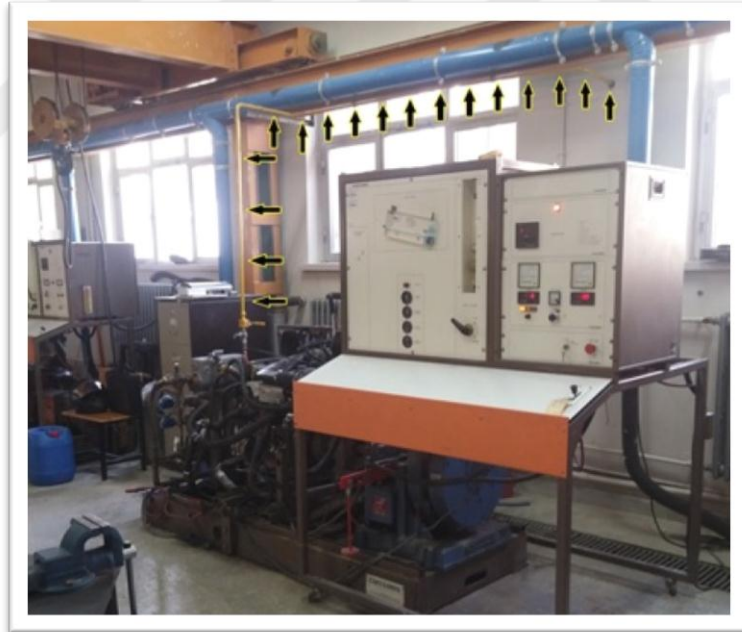
Şekil 8.19. Bina İçerisindeki Düşük Basıncılı Doğalgaz Boruları
