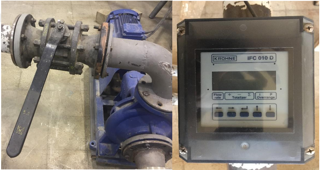
Şekil 5.3 Akım kontrol vanası ve Elektromanyetik debimetre
