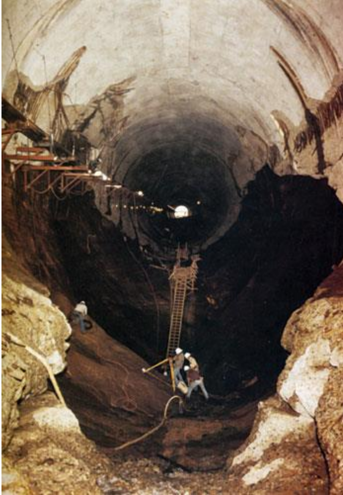
Şekil 3.1. Glen Kanyon Barajında meydana gelen kavitasyon hasarı (1983)
