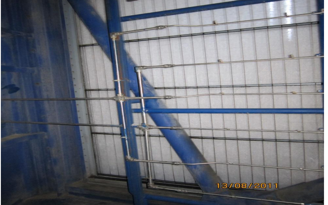
řekil 4.1. Gaz Türbini Hava Emiř Fogging Sistemi
