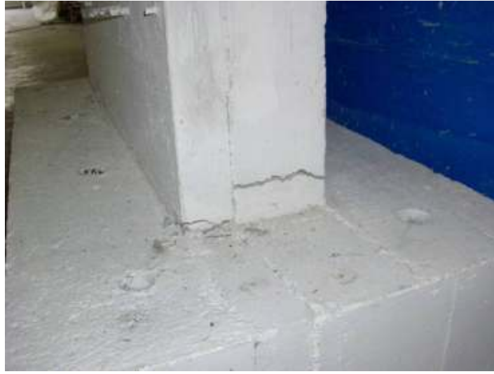
Şekil 6.16. C3DA+ elemanında eğilme çatlakları
