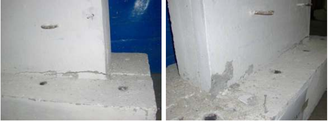
Şekil 6.6. Ankraj oranı yüksek C2 elemanlarda görülen perde eğilme çatlakları
