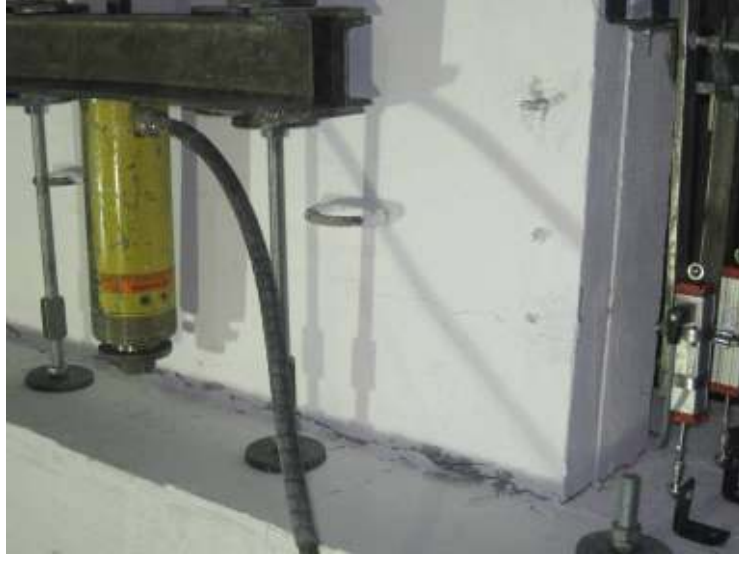
Şekil 6.14. C3BB elemanında perde tabanında eğilme çatlağı
