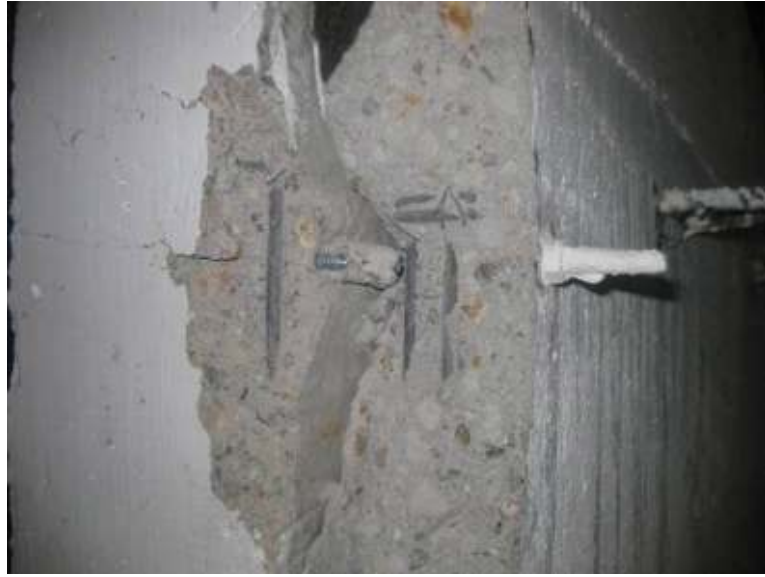
Şekil 6.19. C3DD elemanında kolon ankrajının kopması
