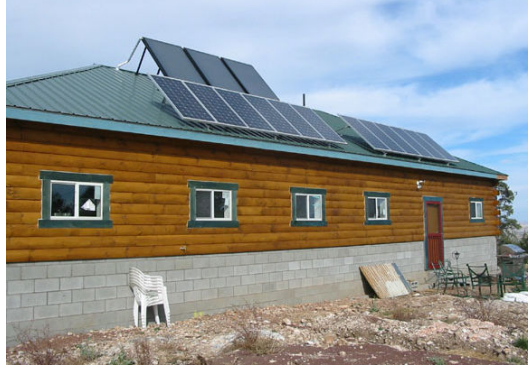
Şekil 3.20. Kolektör ve Pv sistemlerin çatı eğimi ve formundan tamamen farklı bir bütünlük içinde monte edilmiş örnek
