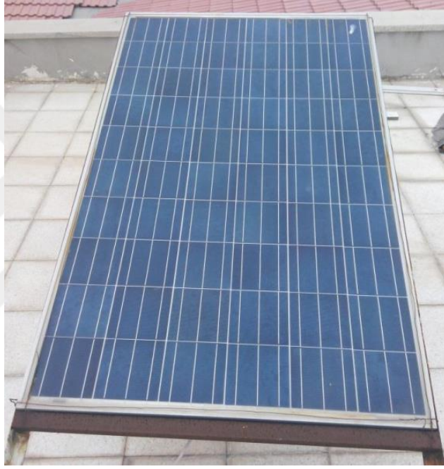
Şekil 2.5 Sistemde kullanılan fotovoltaik panel
