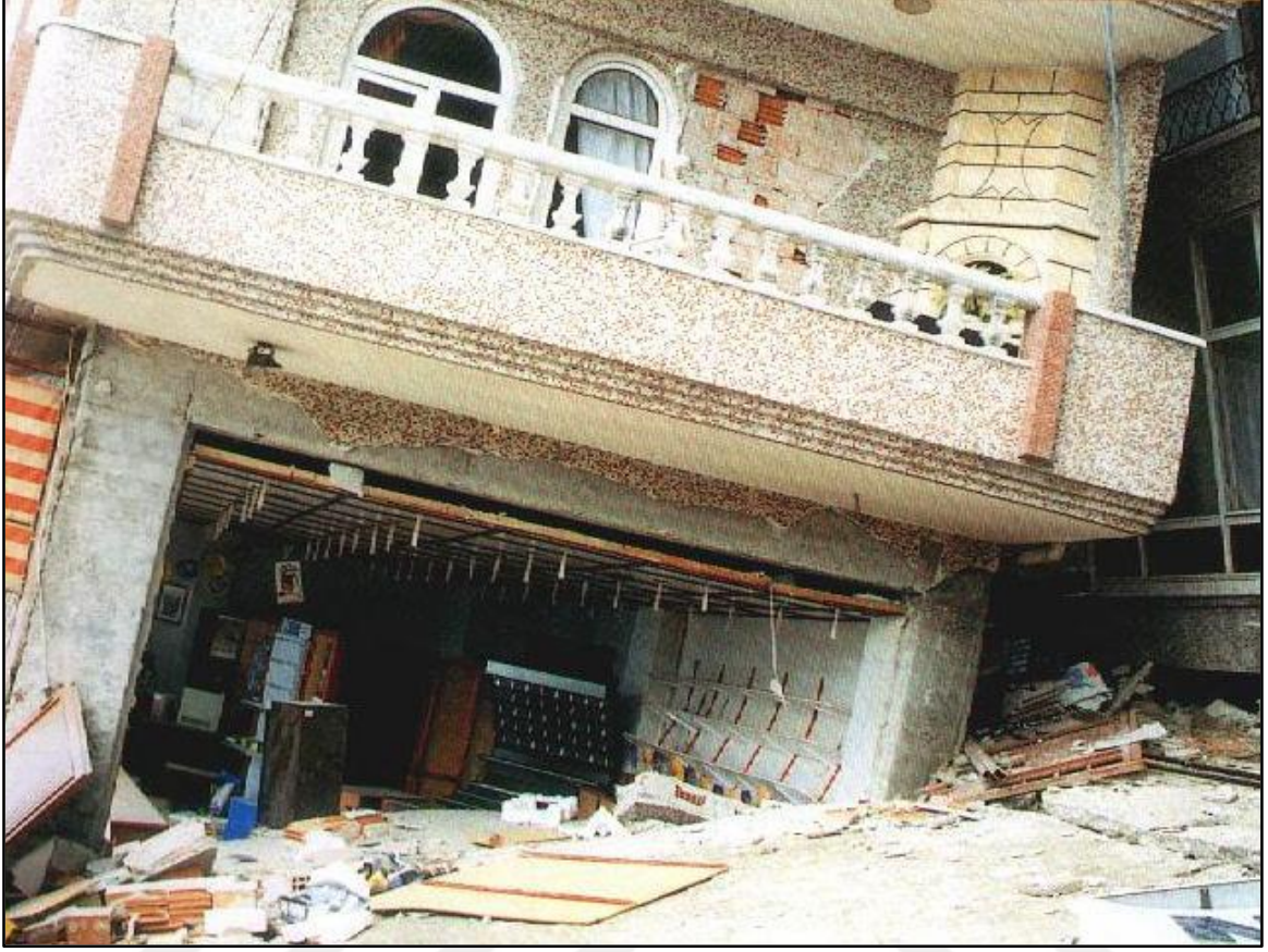
Şekil 3.13. Sıvılaşma sonucu yapılarda gözlenen oturmalar (Şahinalp, 2009).
