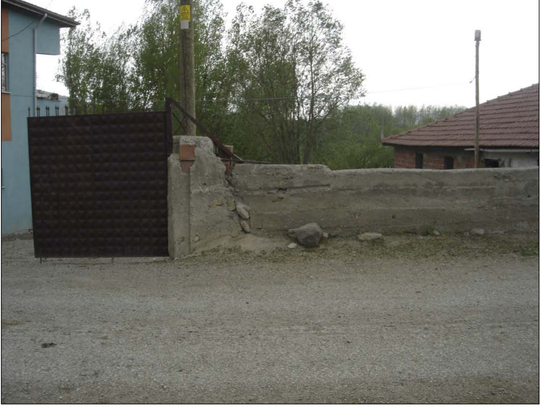
Şekil 4.15. Hamamlı Köyü besi ahırının karşındaki binanın duvarında krip hareketi sonucu meydana gelen sağ yanal deformasyon.
