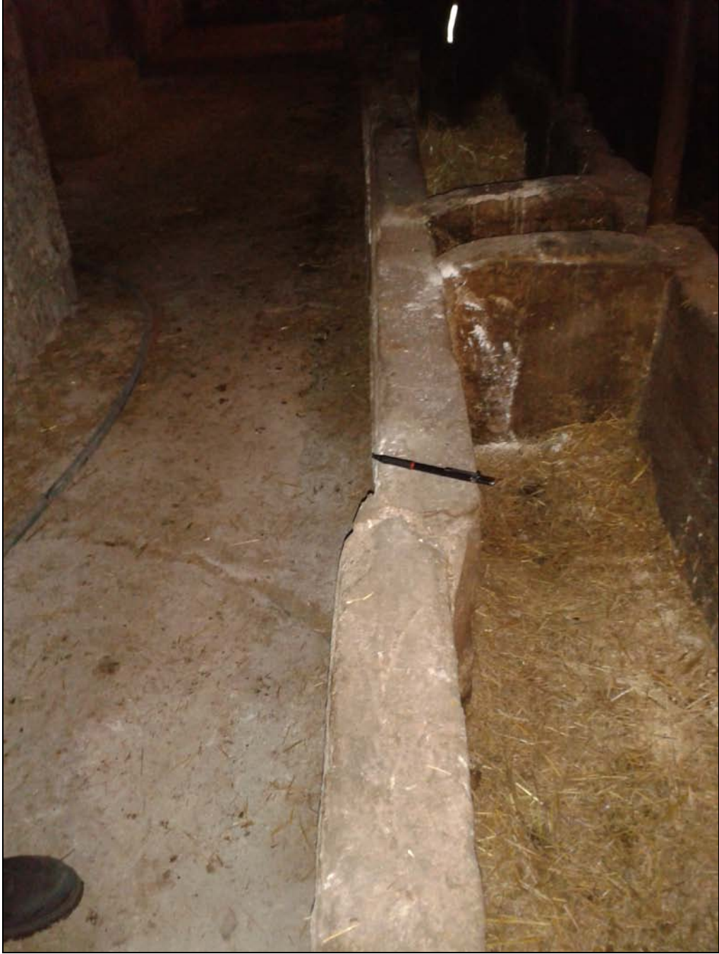
Şekil 4.16. Hamamlı Köyü ahır binasının içinde bulunan duvarda tespit edilen deformasyon.
