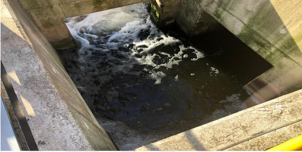
Şekil 2.9. Son Çökeltim Havuzu sonrası atıksu toplama alanı sakin kısmı
