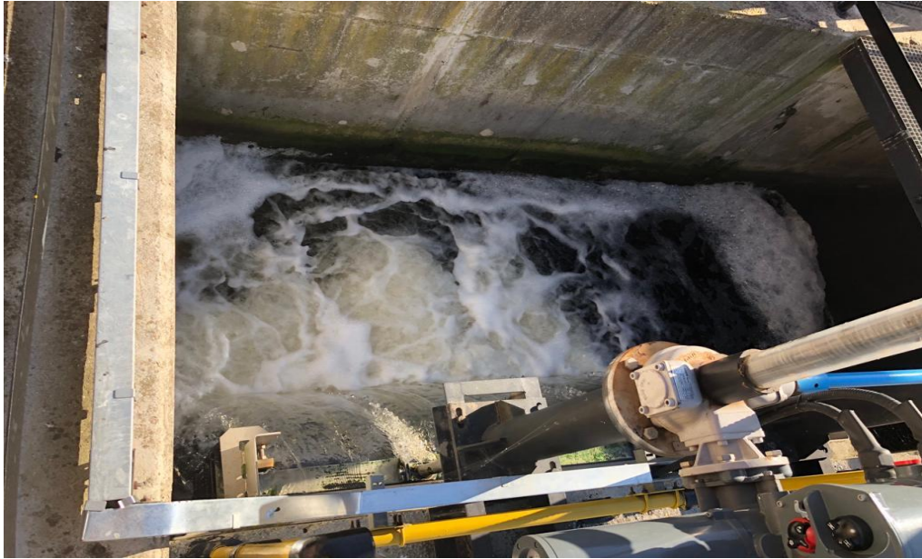
Şekil 2.8. Son Çökeltim Havuzu sonrası atıksu toplama alanı çalkantılı kısmı
