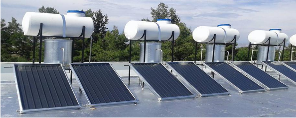
Şekil 3.3. Düzlemsel güneş kolektörleri [19].
