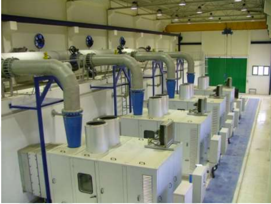
Şekil 4.20. Blower Ünitesi (MASKİ, 2019)
