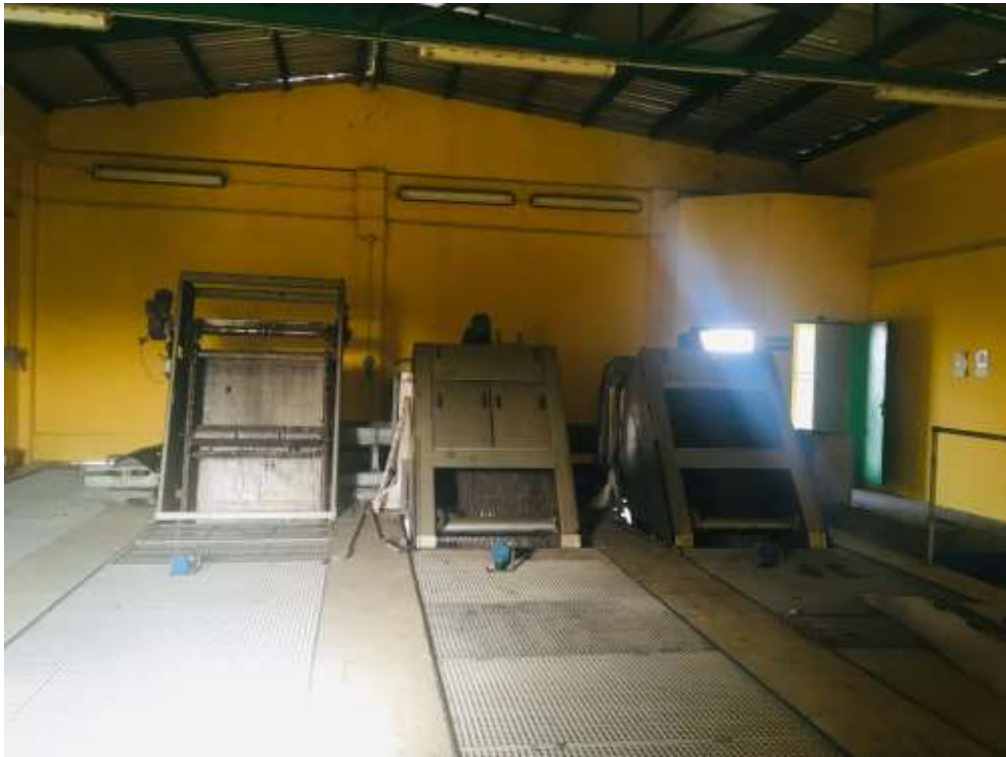
Şekil 3.4. İnce Iızgara Ünitesi (MASKİ, 2019)
