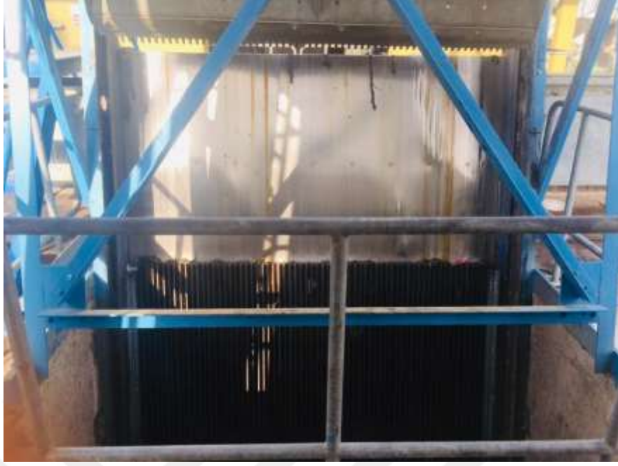
Şekil 3.2. Kaba Izgara Ünitesi (MASKİ, 2019)
