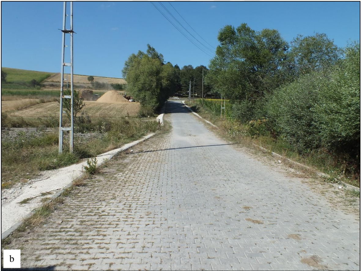
Şekil 5.18. a) Günümüzde kullanılan yol. Sarı ok, yolda sağa doğru görülen dönmenin yerini göstermektedir, b) yolda görülen sağa doğru yamulmanın yakından görünümü. Lokasyonun yeri Şekil 5.15’de verilmiştir.
