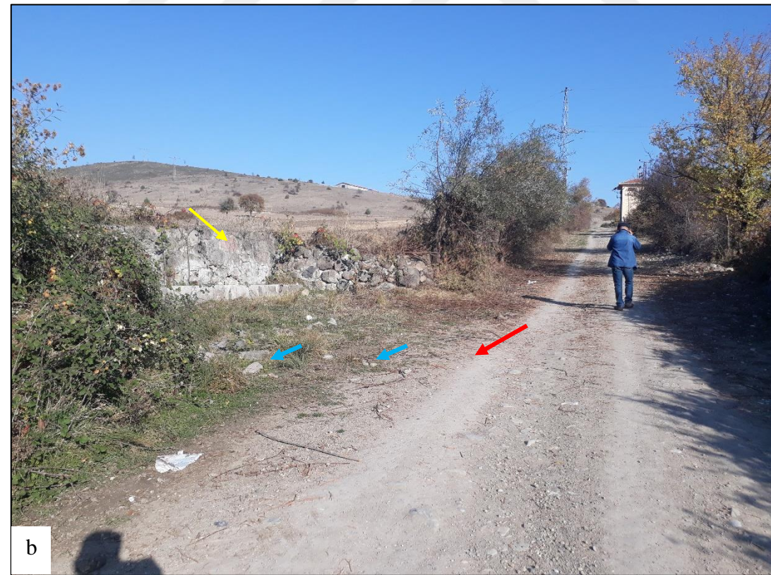
Şekil 5.12. Eski yolun kenarında bulunan çeşmenin görünümü. Çeşmede tamirat izleri görülmektedir. Sarı oklar eski dönemlere ait blokları işaret etmektedir. Mavi oklar yolda kullanılan taş döşemeleri işaret etmektedir.
