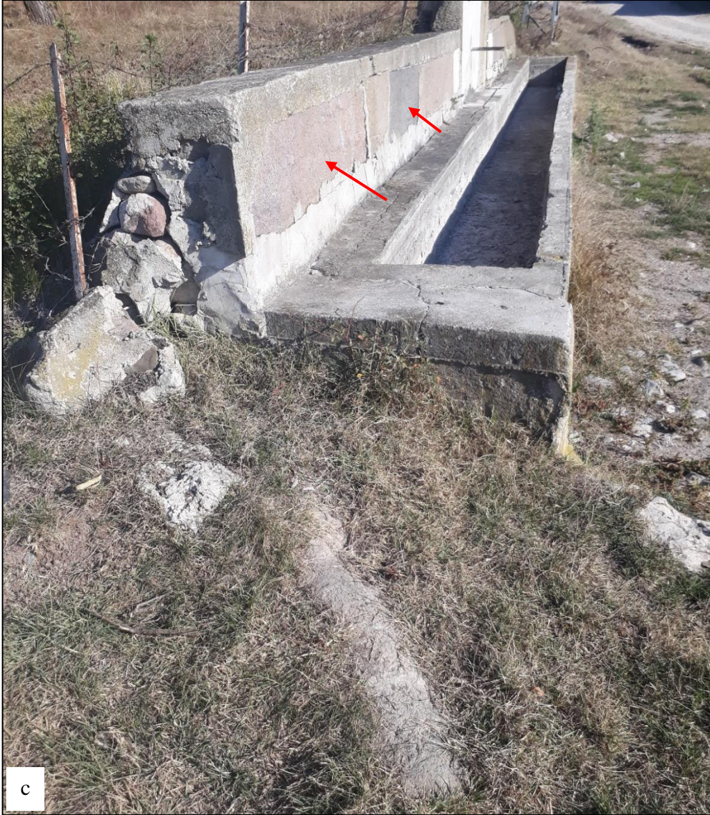
Şekil 5.19. a) Eski yolun kenarında bulunan çeşme (kırmızı ok eski yolu işaret etmektedir, bakış yönü kuzeye doğrudur), b) Gömülü insan yapımı bloklar (sarı ok). c) Çeşmenin yapımında kullanılan eski dönemlere ait insan yapımı bloklar (kırmızı ok). Lokasyonun yeri Şekil 5.15’de verilmiştir.
