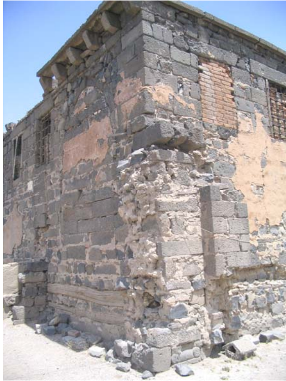
Şekil 5.41 Surp Sargis Kilisesi narteks ve sağ yan cephe köşesindeki duvar kalıntılarının görünümü
