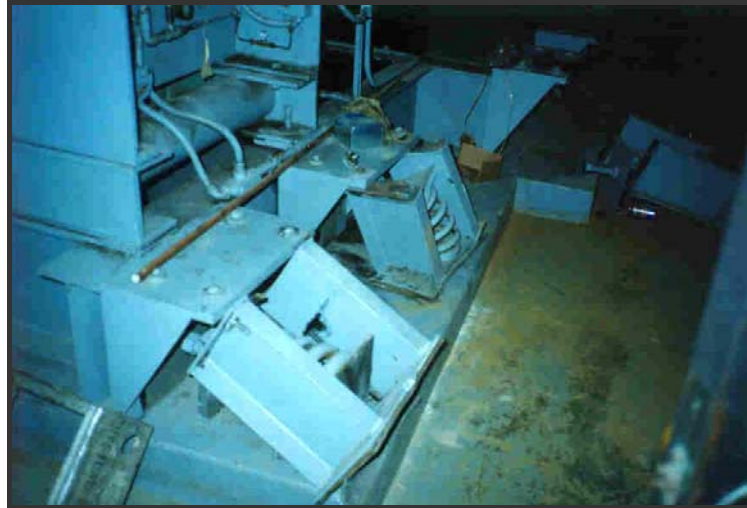
Şekil 2.6. Sismik izolatörleri yanlış seçilmiş ve yanlış monte edilmiş (kaideye bağlanmamış) bir soğutma grubunda, deprem sonrası meydana gelen hasar
