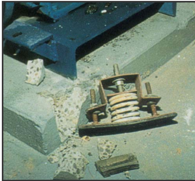
Şekil 2.9. Sismik izolatör ile kaide arası bağlantıdan kaynaklanan hasar
