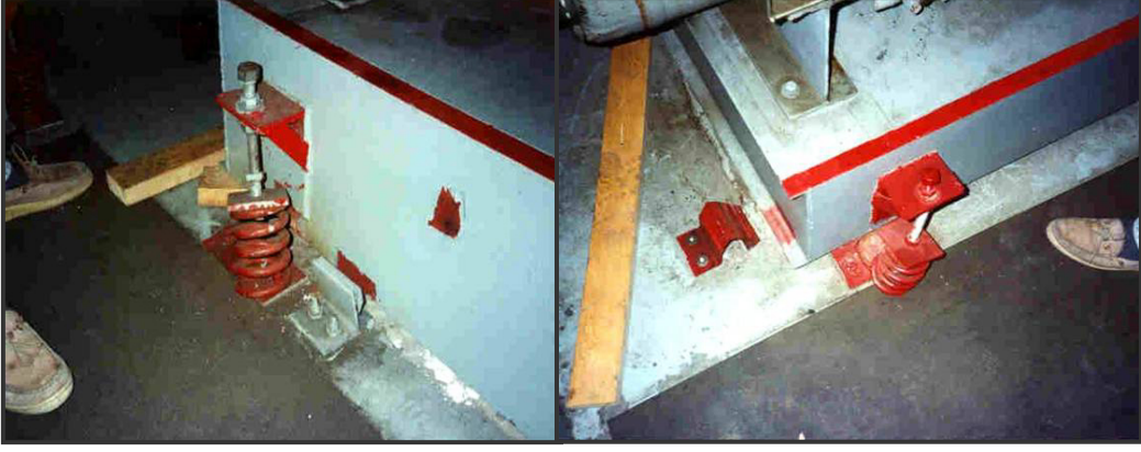
Şekil 2.7. Açık yaylı izolatörlerle birlikte kullanılmak üzere seçilmiş, ancak gereğinden küçük boyutlandırılmış sismik sınırlandırıcılar sebebiyle pompa şasisinde hasar oluşumu
