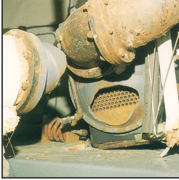
Şekil 2.8. Soğutma grubunun boru bağlantısında meydana gelen hasar
