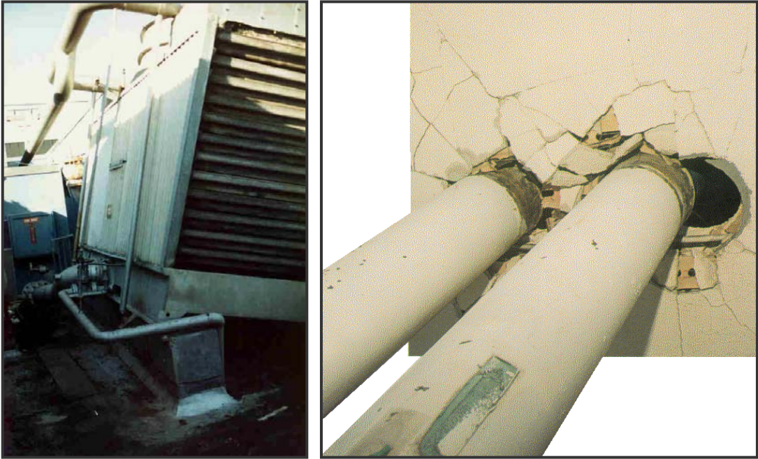
Şekil 2.4. Deprem koruması yapılmamış tesisat donanımlarında hasar oluşumu
