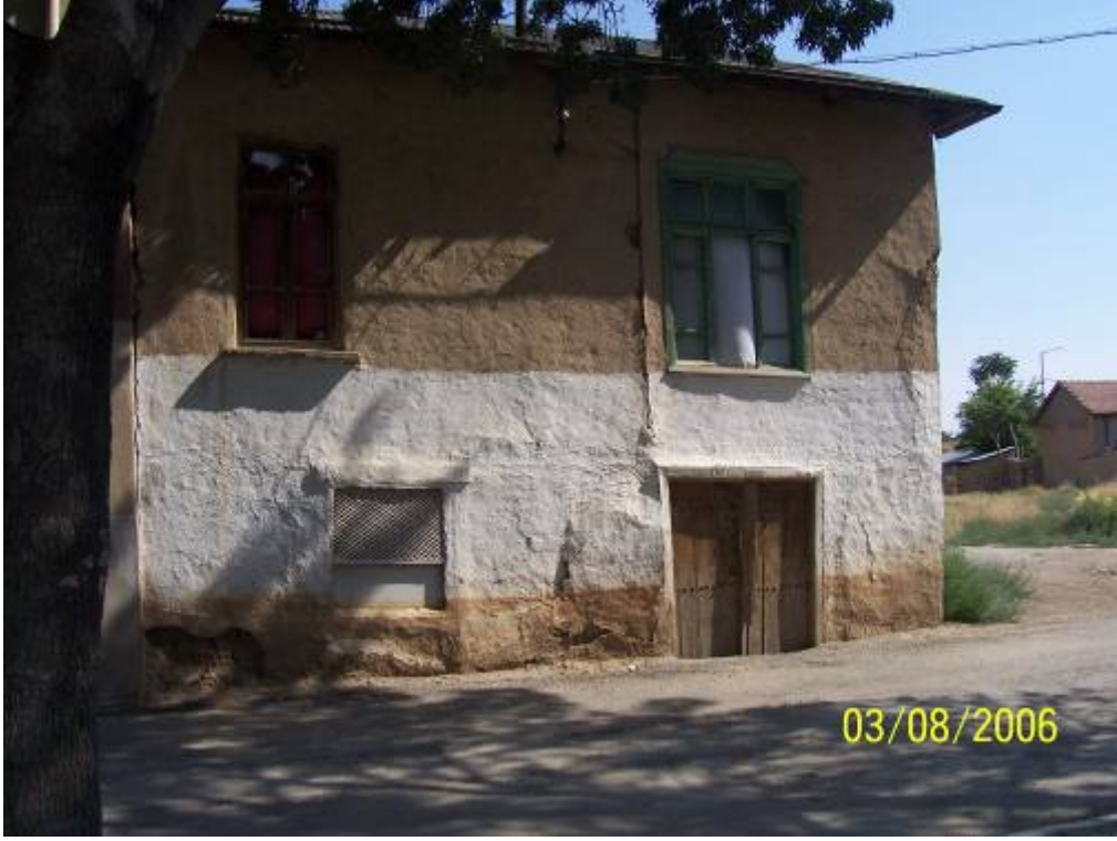
Şekil Ek 2.13 Sedirler caddesinde önünden asfalt yol geçen evin giriş kapısı yol kotundan aşağıda kalmıştır.
