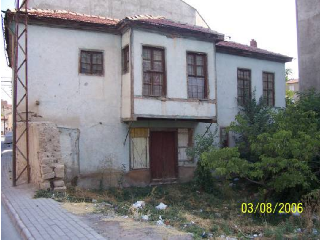
Şekil Ek 2.25 Fenni fırın civarında bir evin yıkılmış hayat duvarı.
