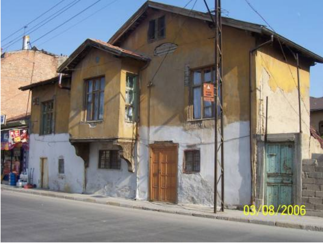
Şekil Ek 2.29 Köprübaşı Karakolu civarındaki evin bağdadi sıvaları dökülmüştür.
