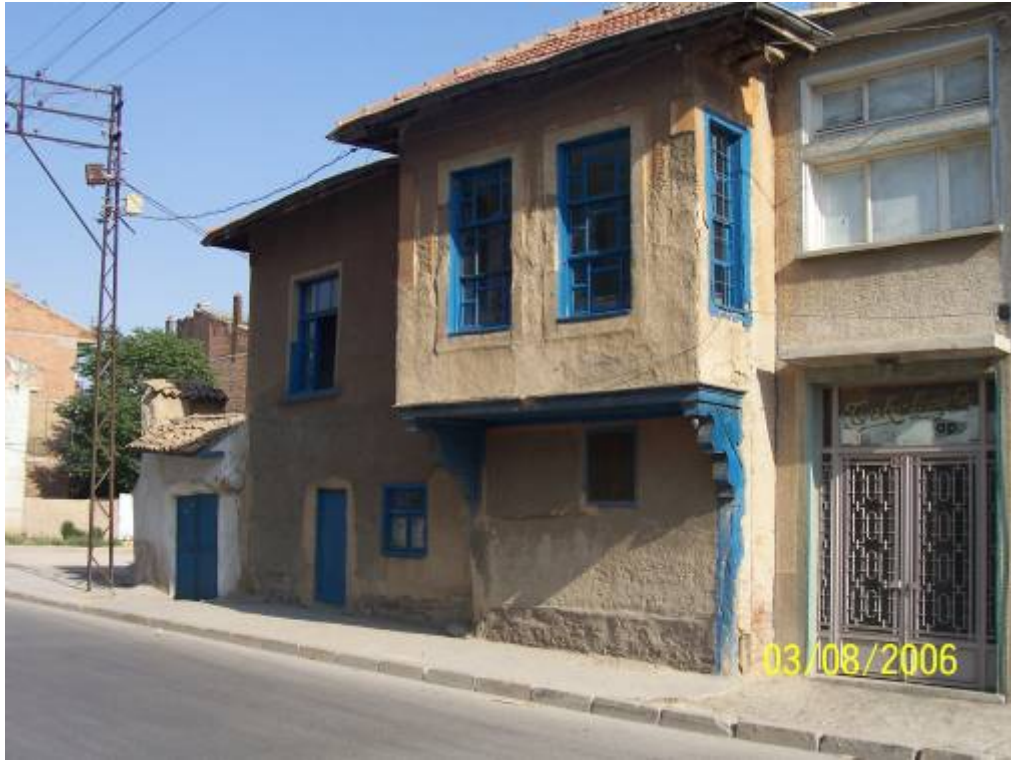
Şekil Ek 2.28 Köprübaşı Karakolu civarına bir ev, ahşap elemanlar özgün rengi bozularak tamamen maviye boyanmış durumdadır.
