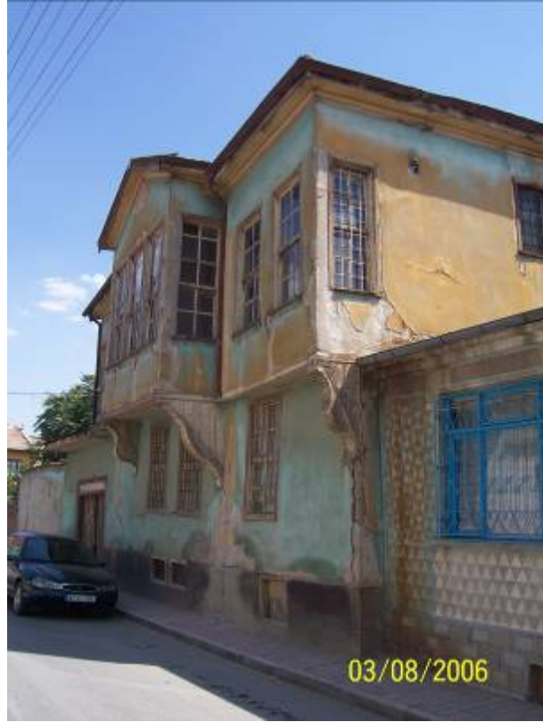
Şekil Ek 2.6 Sonradan çimento sıvanmış ve boyanmış evin sıvaları dökülmüştür.
