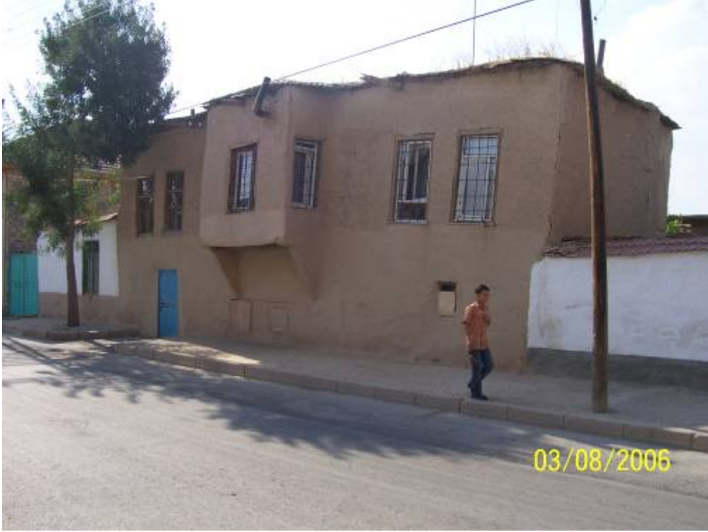
Şekil Ek 2.23 Yediler caddesindeki evin kerpiç duvarı kayma yapmış fakat ev halen kullanılmaktadır.
