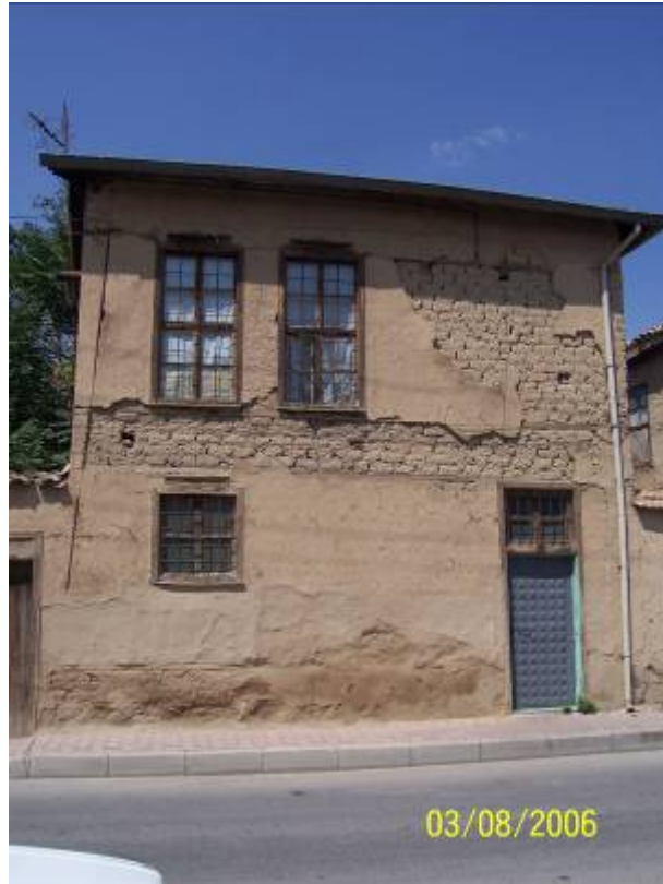
Şekil Ek 2.4 Konya sokağında cephe sıvaları dökülmüş evin kerpiçleri görünmektedir.
