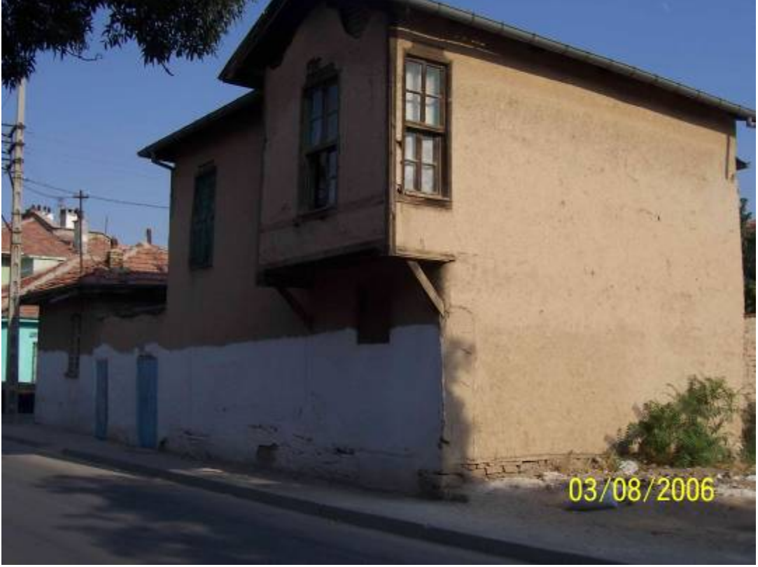
Şekil 4.73 İşgalaman caddesindeki ev, yan duvarda temel üstü ahşap hatıl görülmektedir.
