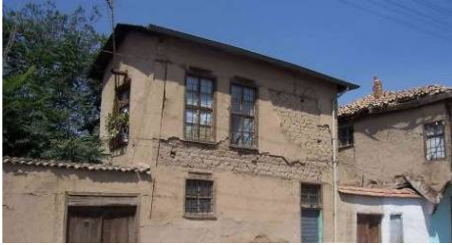
Şekil 4.77 Türbe civarındaki bir evin cephesindeki sıva dökülmeleri.
