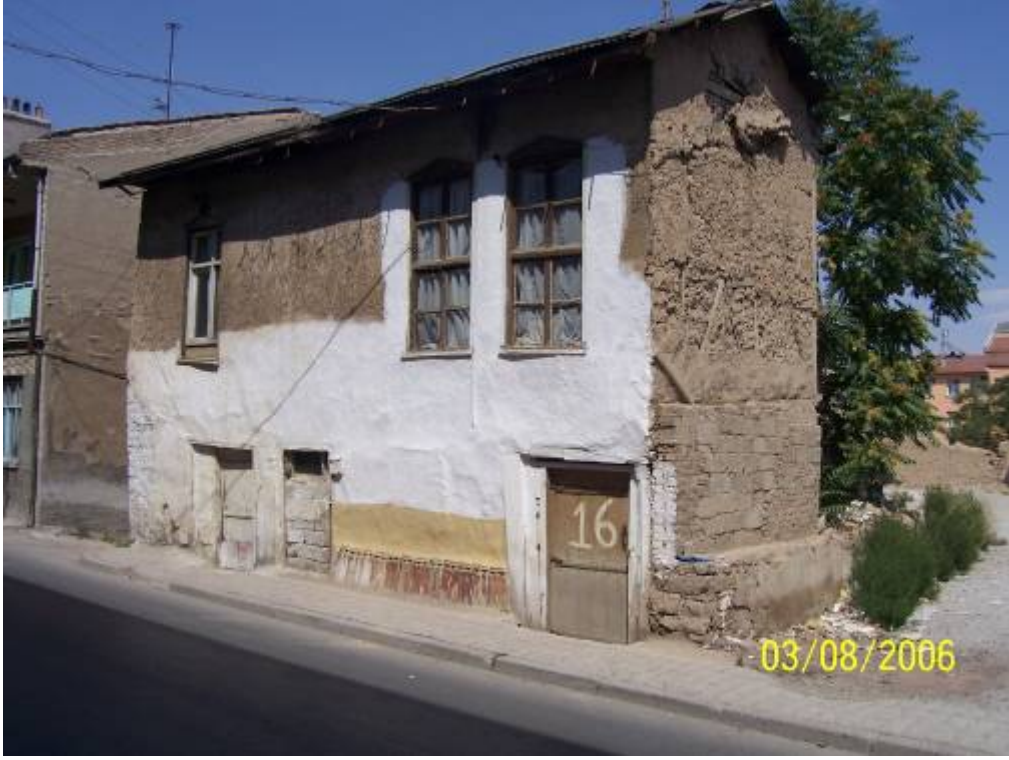
Şekil Ek 2.7 Köprü Başı caddesindeki 16 nolu evin yan duvarında ahşap çatıklı hımış duvar görülmektedir.
