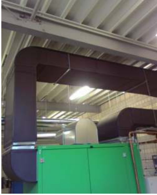
Resim 2.3 Sistem Havalandırma Kanalı
