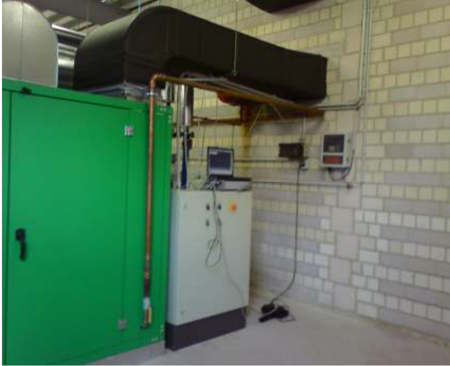
Resim 2.2 Sistemin Temiz Hava Besleme Kanalı, Elektrik Panosu ve Ölçüm Sistemi
