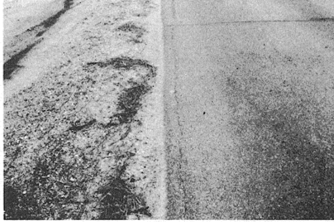
Şekil 4.33 Düşük yoğunlukta kenar çatlağı (Shahin, 2002)
