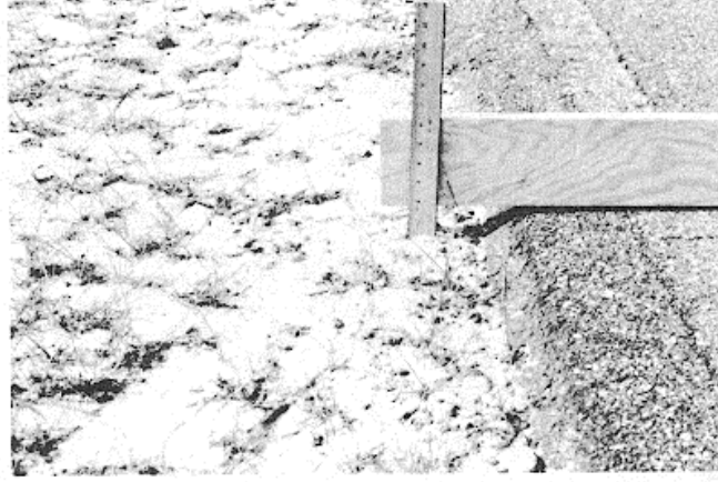
Şekil 4.39 Düşük yoğunlukta kenar / banket düşüklüğü (Shahin, 2002)
