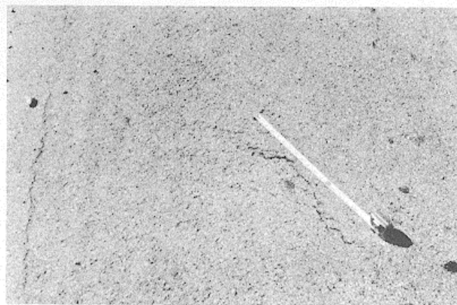
Şekil 4.61 Düşük yoğunlukta tabaka kayması çatlağı (Shahin, 2002)
