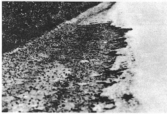
Şekil 4.35 Yüksek yoğunlukta kenar çatlağı (Shahin, 2002)
