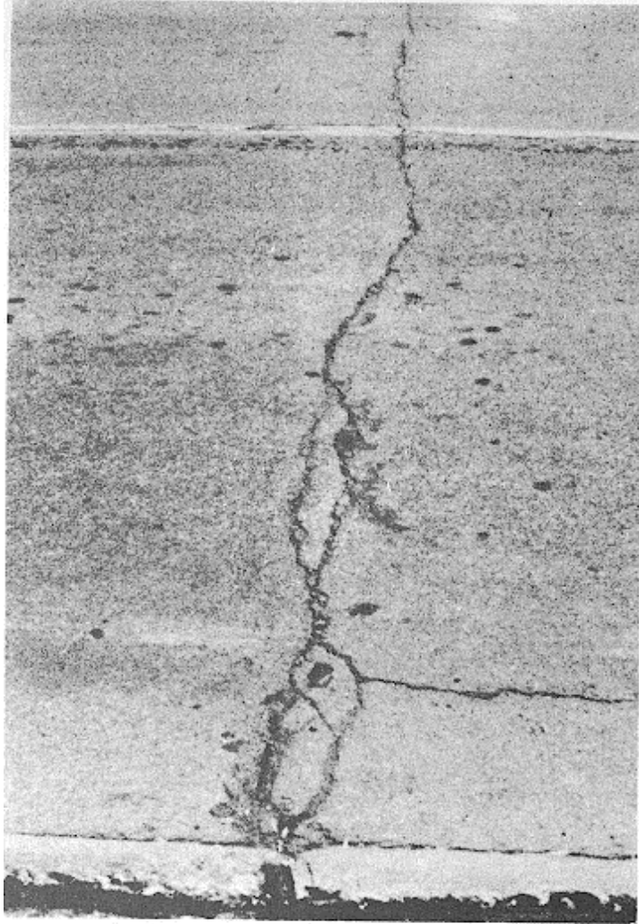
Şekil 4.37 Orta yoğunlukta yansima çatlağı (Shahin, 2002)
