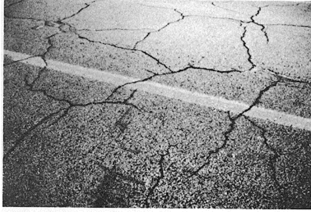
Şekil 4.22 Orta yoğunlukta blok çatlak (Shahin, 2002)
