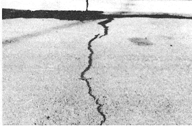
Şekil 4.43 Orta yoğunlukta boyuna ve enine çatlaklar (Shahin, 2002)
