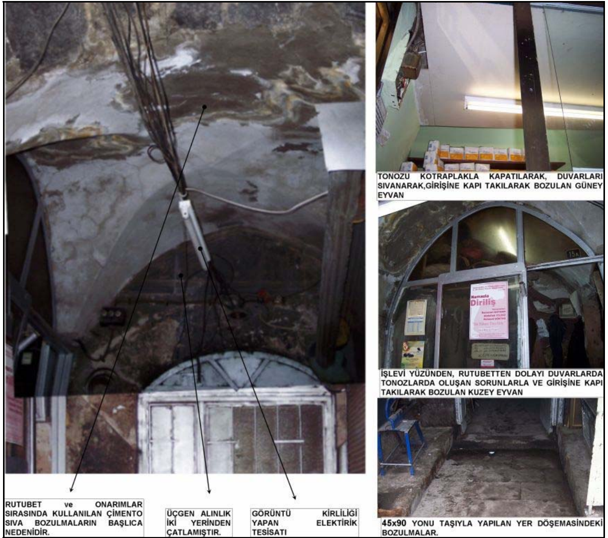
Şekil 5.60 Bedestenin giriş revağındaki ve buranın eyvanlarındaki bozulmalar ve sorunlar.
