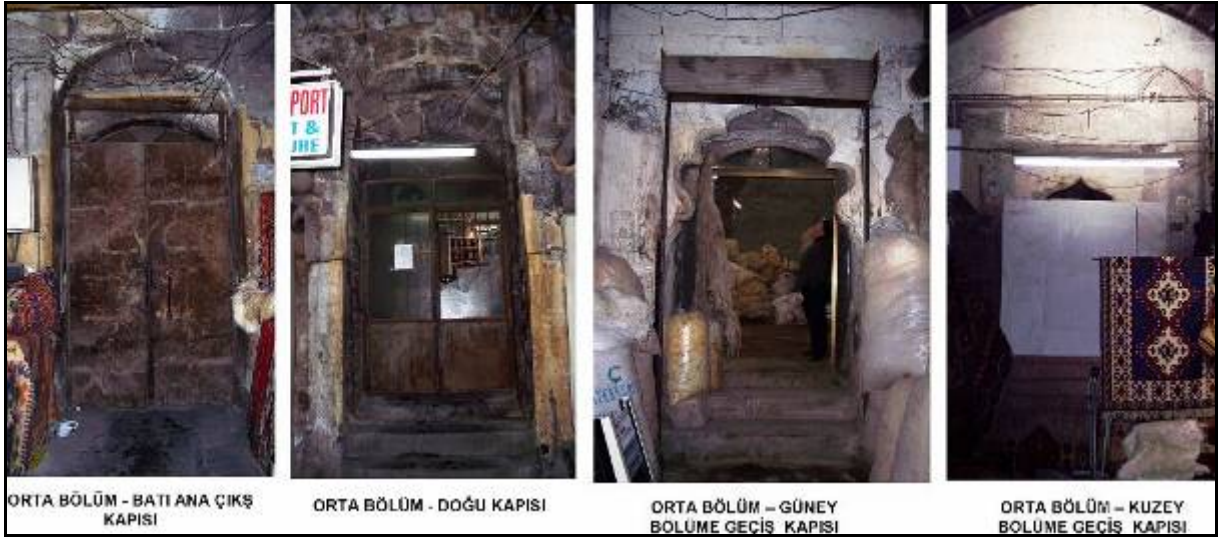
Şekil 5.62 Bedestenin orta bölümünün dört yöne açılan dört kapısındaki bozulmalar.
