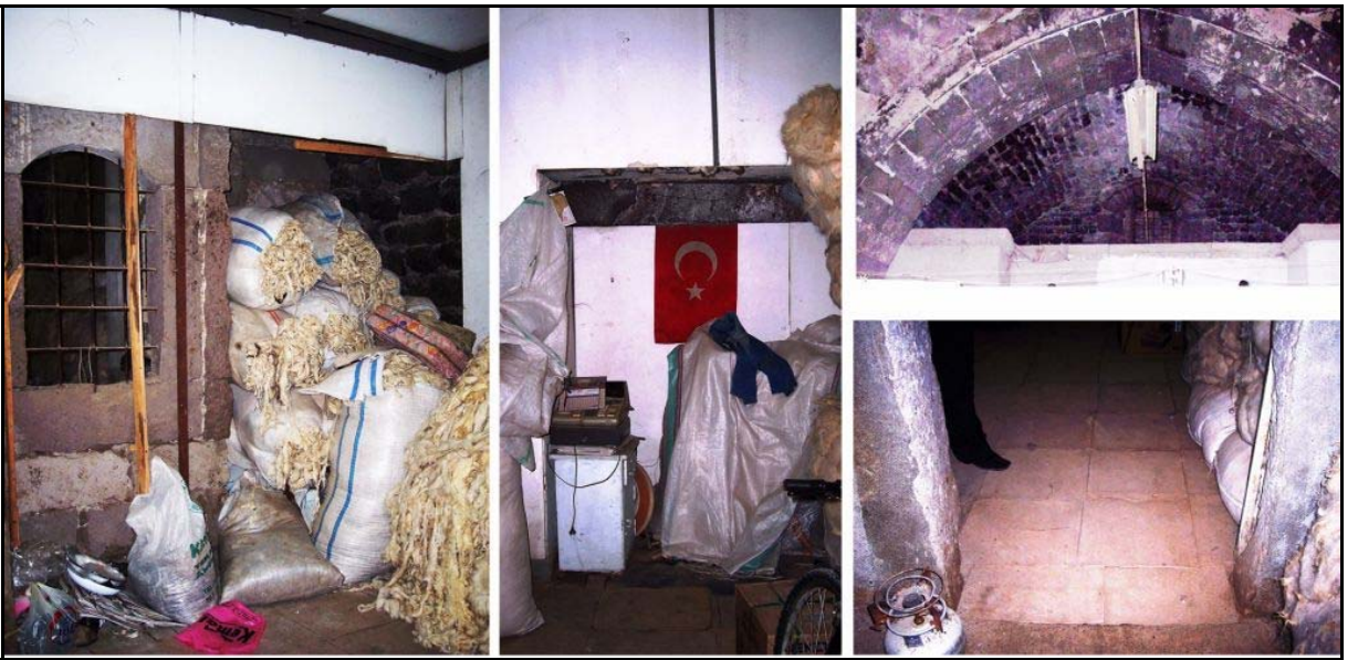
Şekil 5.65 Bedestenin güney bölümünün batı kanadındaki bozulmalar.
