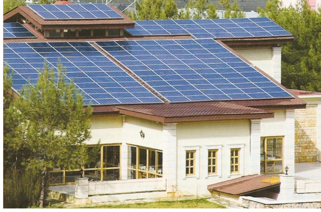
Şekil 5.35 Çatıda uygulanmış fotovoltaiik paneller [62]
