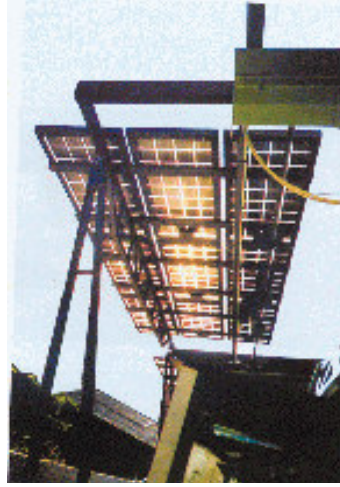
Şekil 5.71 Fotovoltaik hareketli sundurmanın aşağıdan görünüşü (Bozdoğan, 2003)
