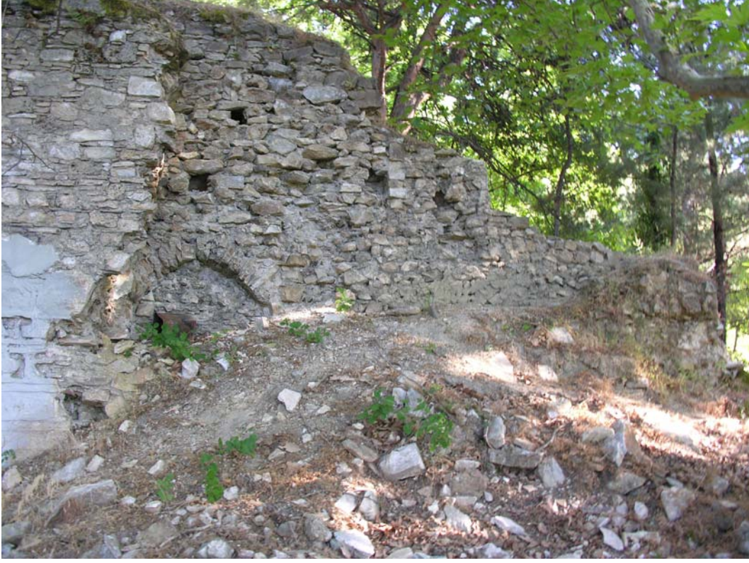
Şekil 46 - Kilise, kuzey duvarı, yıkılan bölüm
