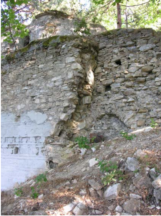
Şekil 47 - Kilise, kuzey duvarı, yıkılan bölüm
