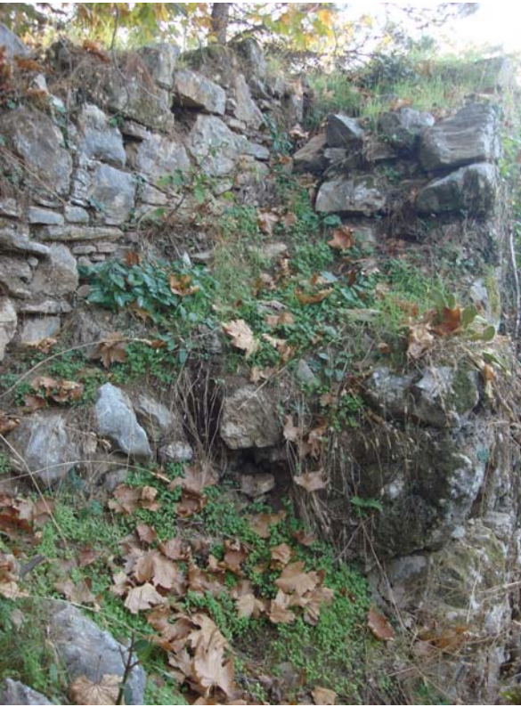
Şekil 23 - Kuzey çevre duvarı, dış duvarın yıkık olduğu bölüm
