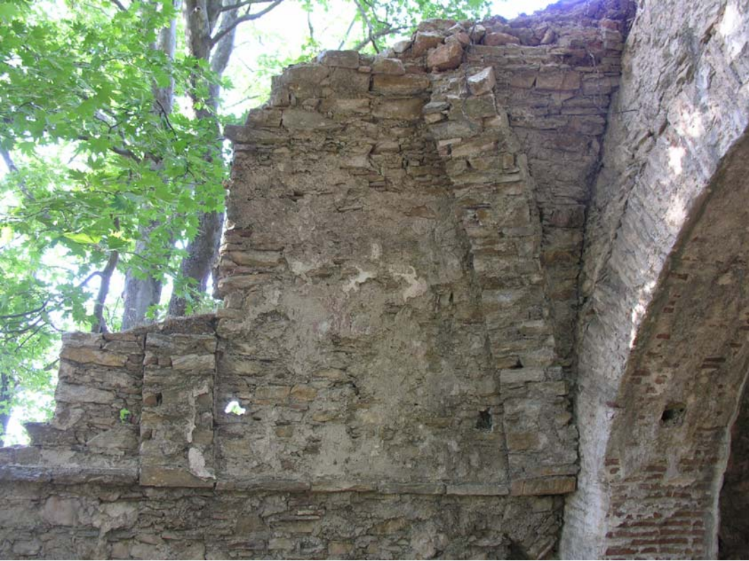
Şekil 95 - Kilise, batı giriş mekanı, kuzey duvarındaki çapraz tonoz kalıntısı
