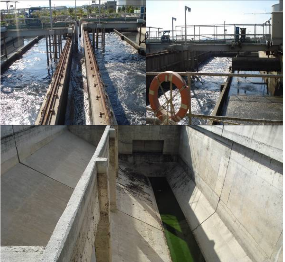
Şekil 1.5 Atıksu arıtma tesisi örnekleri
