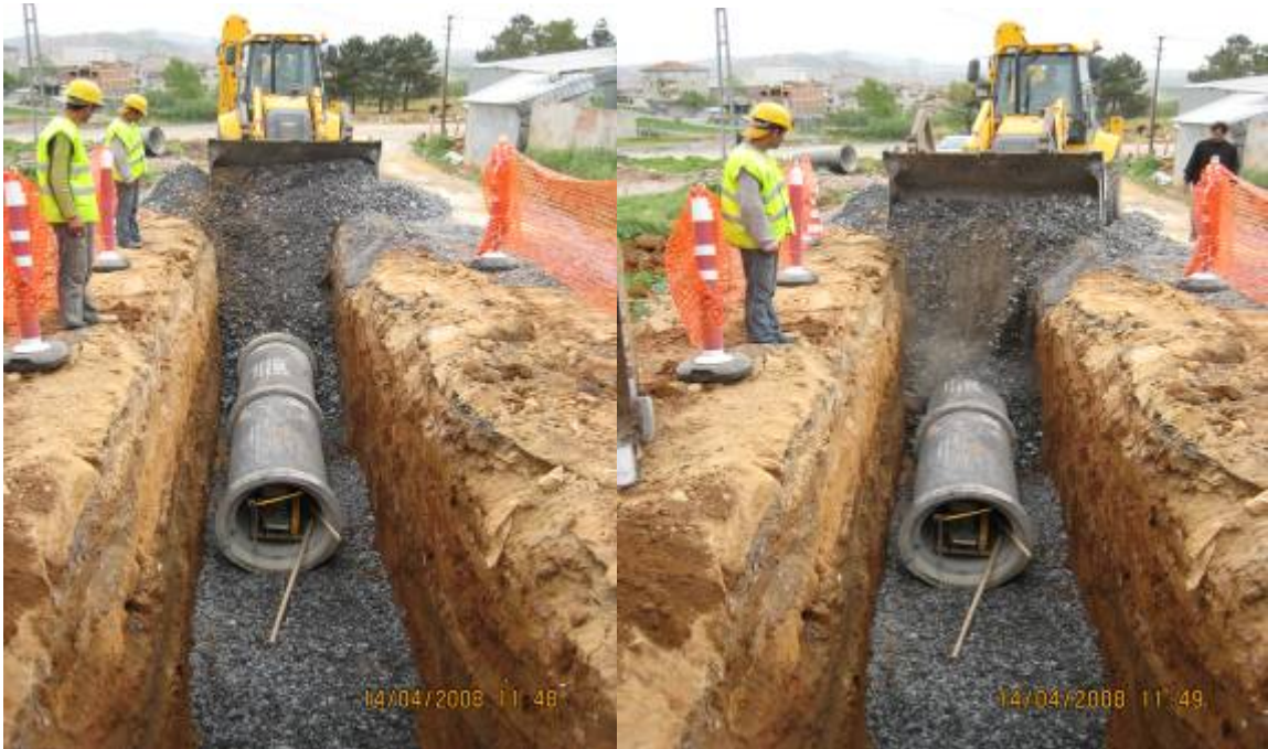
Şekil 1.2 Atıksu şebeke imalatı
