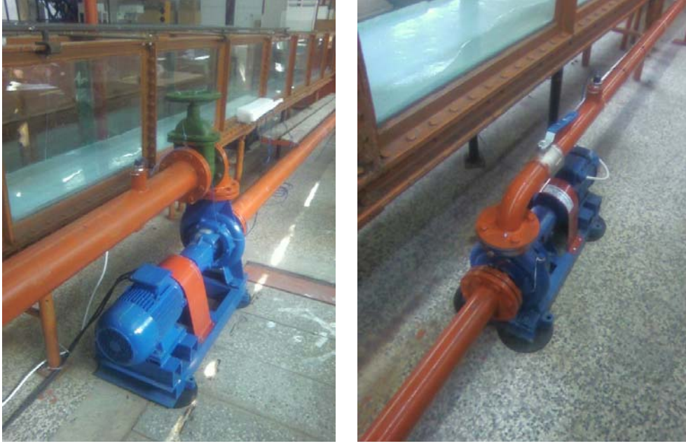
Şekil 3.3 Kanalda kapalı sirkülasyonu sağlayan pompalar
