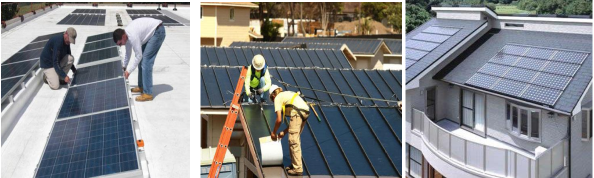
Şekil 5.19 Çatılarda PV uygulaması [49], [118], [119]
