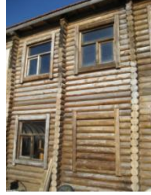
Şekil 2. 62-b Güneşe bakan cephede oluşan renk değişimi [41]
