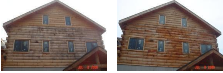
Şekil 2. 54 Kütük yapı duvarında küflenme ve sonrasında küfün temizlenmesi [119]
