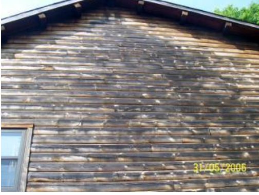
Şekil 2. 62-a Ahşap yığma yapı cephesinde meydana gelen kararma [90]
