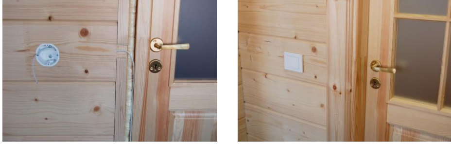
Şekil 3. 119 Kapının kenarından geçirilip anahtar kutusuna ulaşan elektrik kablosu [232]
