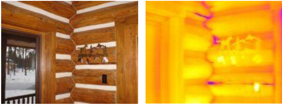
Şekil 2. 40 Kızılötesi ısısal görüntüleme yöntemi ile çatlakların belirlendiği duvarlar [83]
