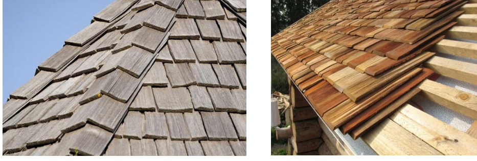
Şekil 3. 229 Ahşap “shingle” kaplı çatılar [304], [253]
