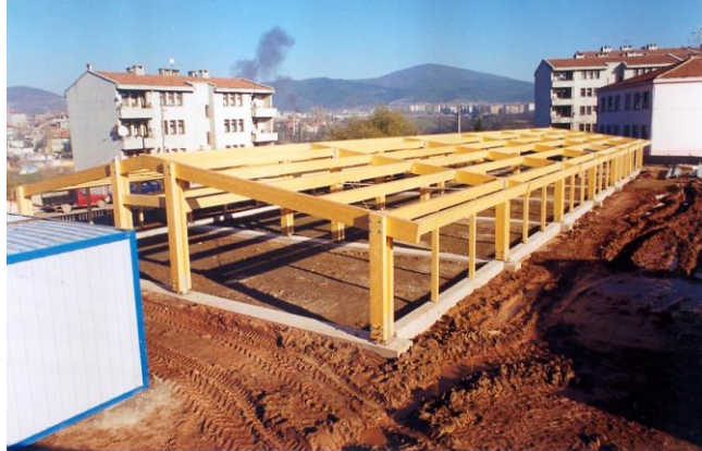
Şekil 5. 31 Sökülüp taşınabilir geçici eğitim yapısı ahşap karkas sisteminin montajı tamamlandıktan sonra görünümü [160].
