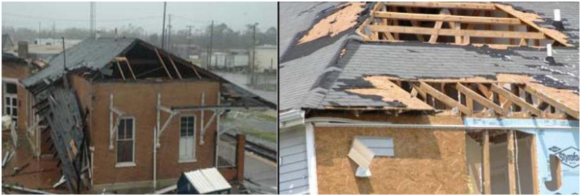
Şekil 4.70 Çatı kaplamalarında oluşan hasarlar [57]
