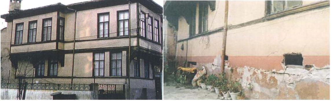
Şekil 4.24 Zemin kat duvarında görülen kesme çatlağı [41]
