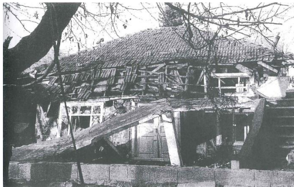
Şekil 4.30 Ahşap yapının çatısında görülen hasar [41]
