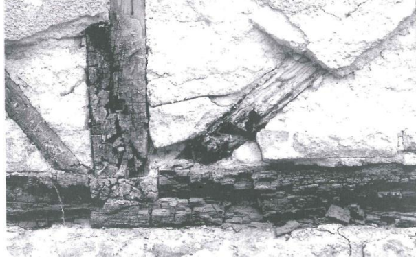
Şekil 4.32 Rutubet nedeniyle ahşap malzemenin bozulması [41]
