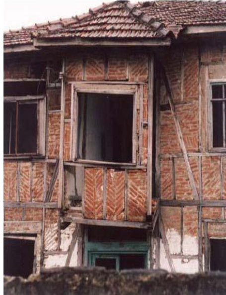
Şekil 4.28 Konsol elemanlarında görülen eğilmeler [41]
