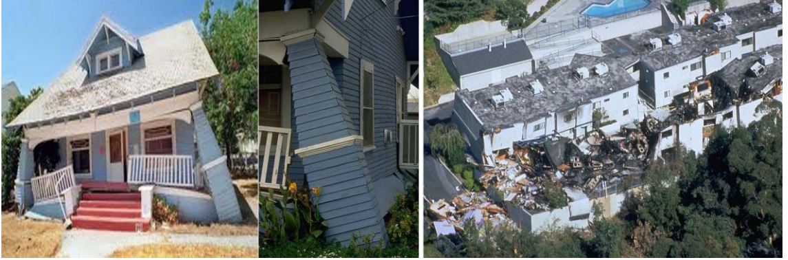
Şekil 4.2 Northridge depremi sonrası ahşap yapılarda görülen hasarlar [46]
