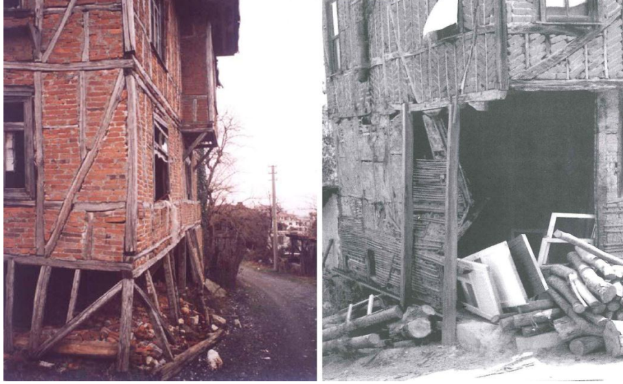
Şekil 4.34 Taşıyıcı sistemde görülen hasarlar [41]
