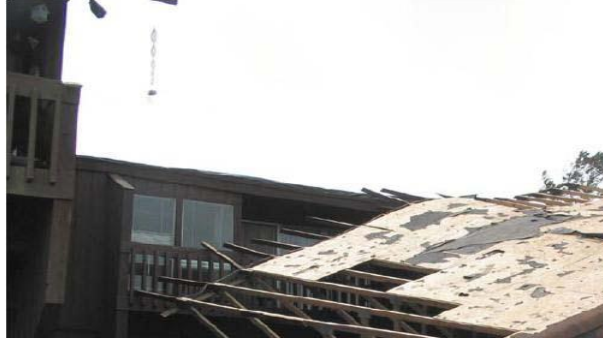
Şekil 4.66 Çatıda oluşan hasarlar [61]
