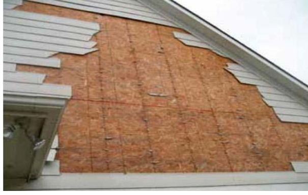
Şekil 4.58 Köşelerde oluşan malzeme kayıpları [60]
