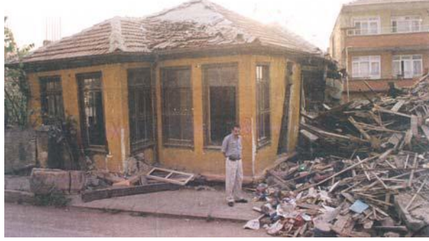
Şekil 4.23 Zemin katın yıkılması sonucunda, birinci katın oturması [41]
