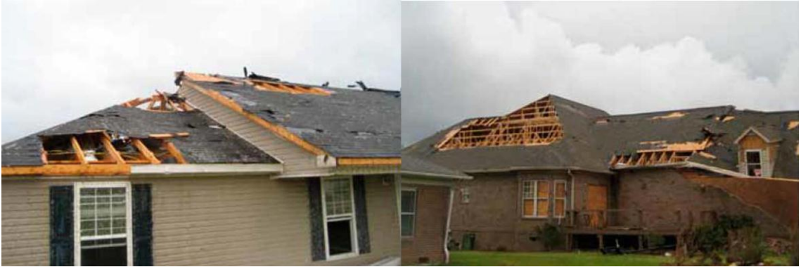
Şekil 4.69 Çatı kaplamalarında oluşan hasarlar [60]
