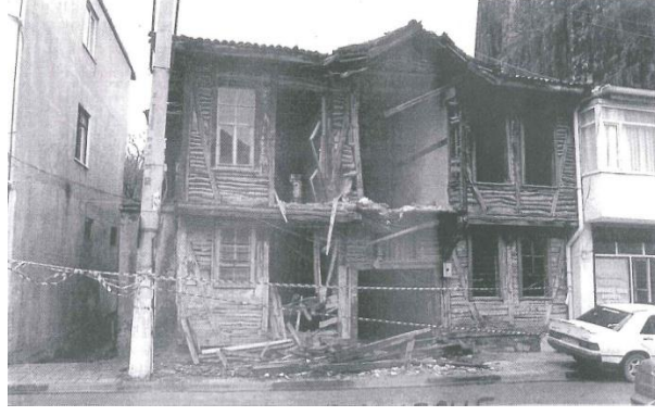
Şekil 4.26 Balkonu yıkılmış ahşap yapı [41]
