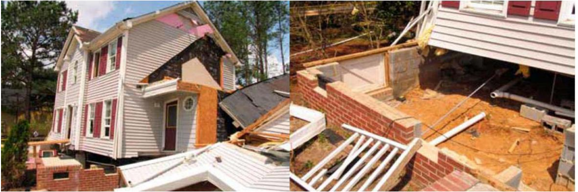
Şekil 4.45 Ahşap yapının temel üzerinde kayması [60]
