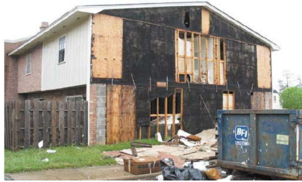
Şekil 4.59 Islanan cephe kaplamaları [61]
