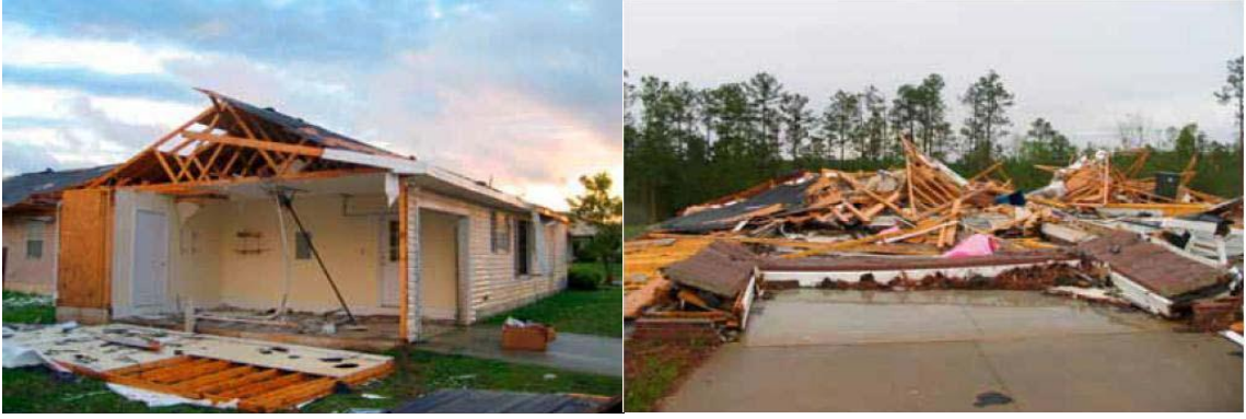
Şekil 4.62 Garajda oluşan basınç etkisinin neden olduğu yıkımlar [60]
