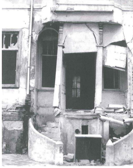
Şekil 4.18 Ahşap yapılarda görülen yanal ötelenmeler [41]
