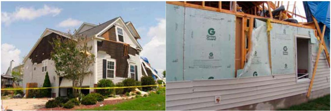
Şekil 4.56 Cephelerde oluşan malzeme kayıpları [60]
