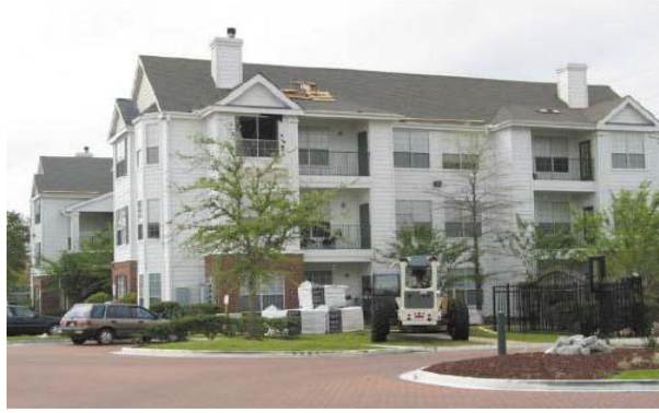
Şekil 4.61 Camları kırılan yapı [61]
