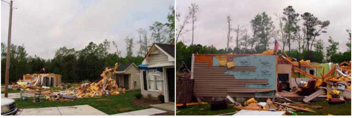
Şekil 4.52 Ahşap yapıda oluşan yıkım [60]
