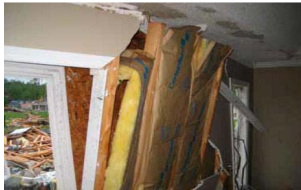
Şekil 4.54 Duvar katmanlarında oluşan hasar [60]
