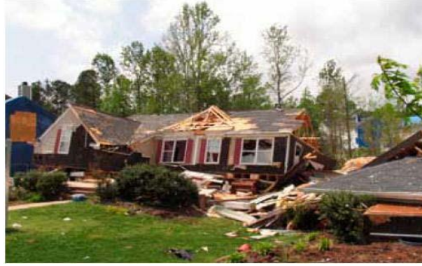
Şekil 4.53 Ahşap yapının zemin katında oluşan yıkım [60]
