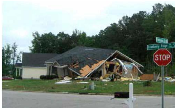
Şekil 4.51 Duvar yıkımının yapıda oluşturduğu hasar [60]
