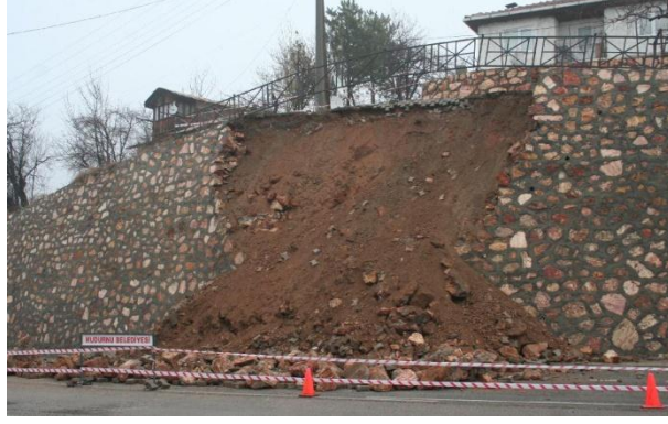
Şekil 4.13 Deprem nedeniyle oluşan toprak kaymaları [46]
