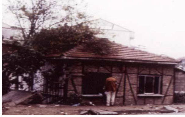
Őekil 4.15 Sıvılařma nedeniyle ahřap yapı temelinde oturma [41]
