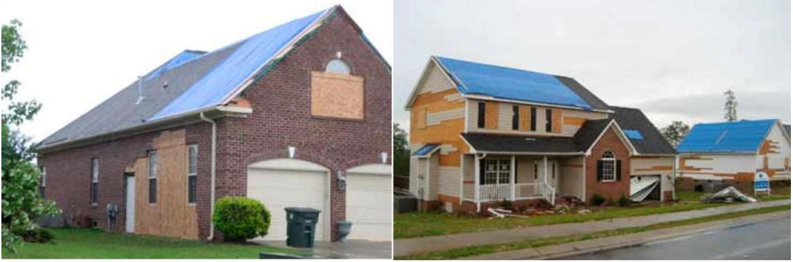
Şekil 4.55 Cephelerde oluşan malzeme kayıpları [60]
