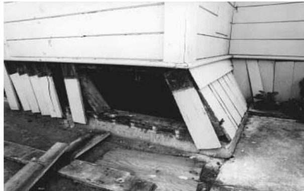
Şekil 4.8 Ahşap yapının bir bütün halinde yükseltilmiş zemin üzerinden kayması [52]
