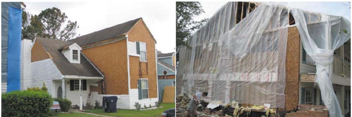
Şekil 4.57 Cephelerde oluşan malzeme kayıpları [61]
