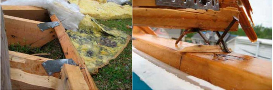
Şekil 4.82 Yanlış bağlantı uygulaması [60]
