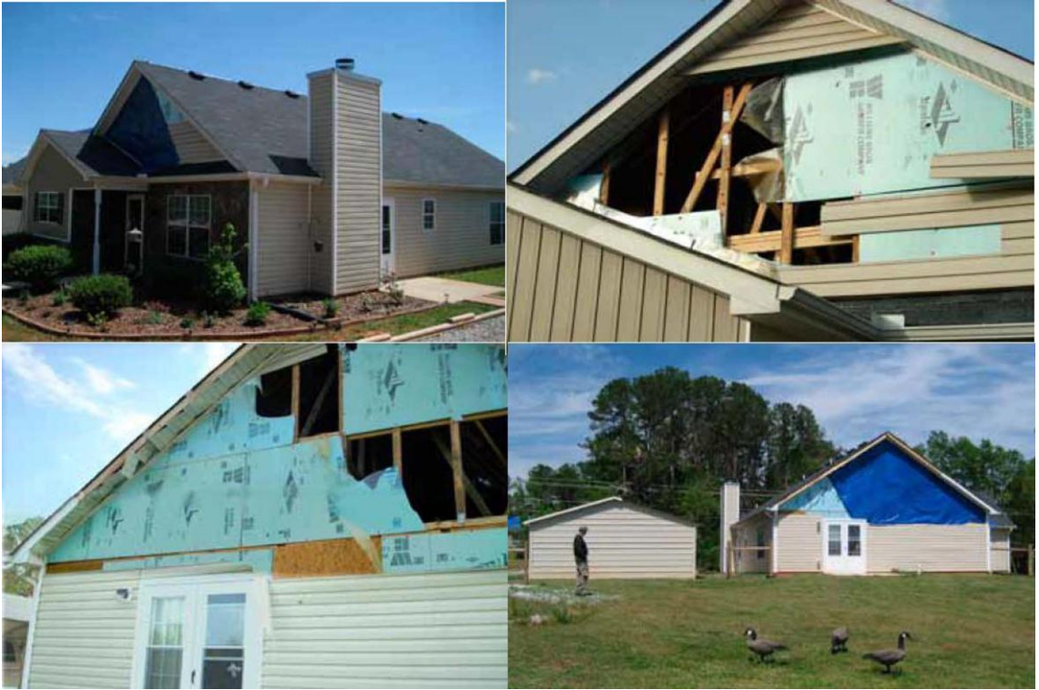
Şekil 4.72 Kalkan duvarlarında görülen hasarlar [60]
