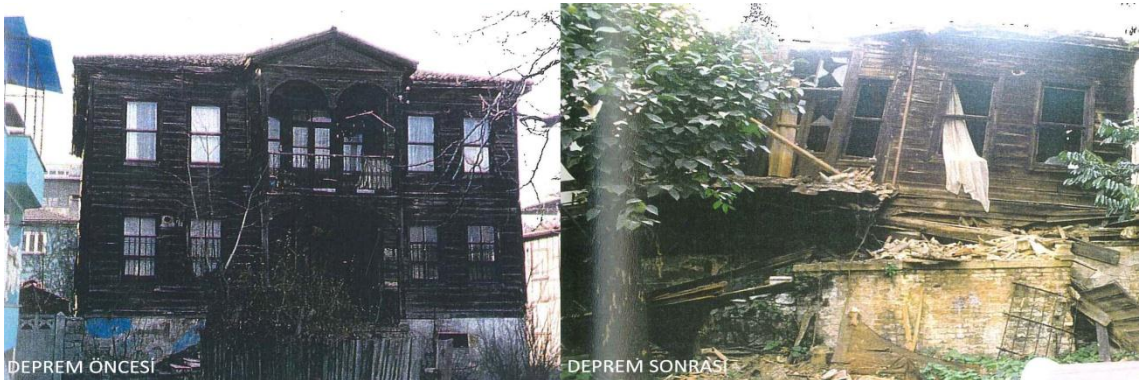
Şekil 4.20 Zemin ve birinci katı yıkılan ahşap yapı [41]
