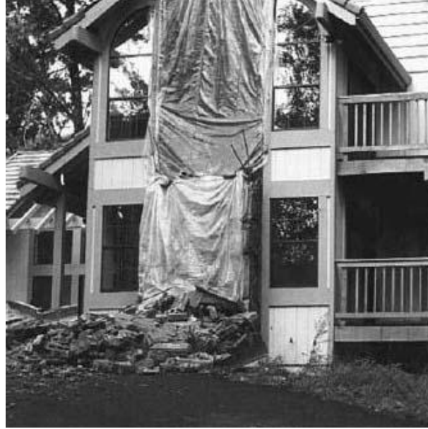
Şekil 4.31 Ahşap yapının bacasının yıkılması [52]
