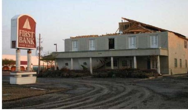
Şekil 4.65 Çatının bir kısmının uçması [57]
