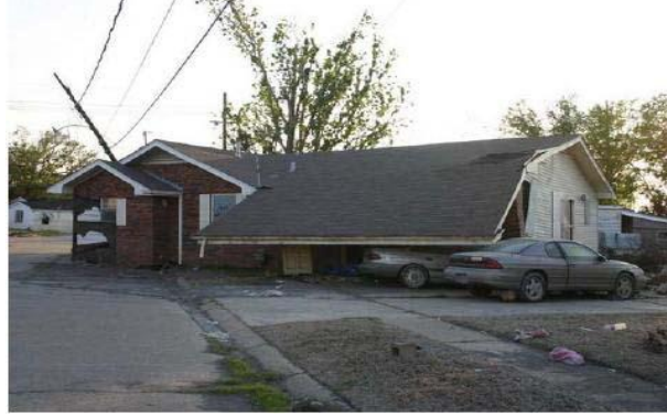
Şekil 4.79 Sundurmalarda görülen hasarlar [57]
