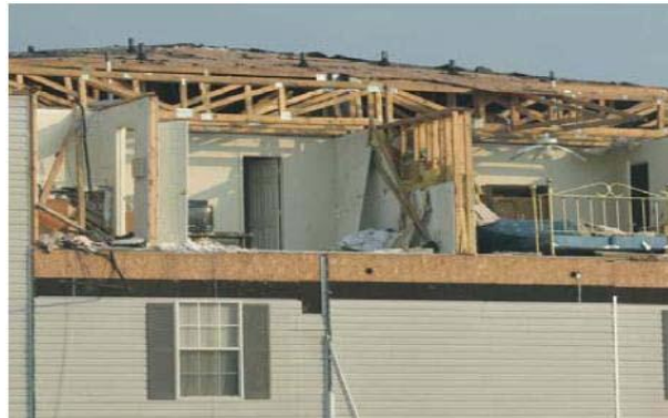
Şekil 4.67 Çatı makaslarının uçması [57]
