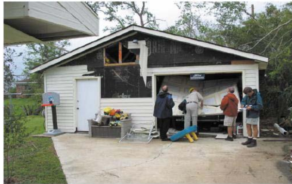
Şekil 4.64 Garaj kapısında görülen eğilme [61]
