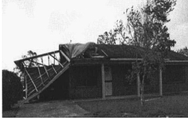
Şekil 4.80 Sundurmalarda görülen hasarlar [59]
