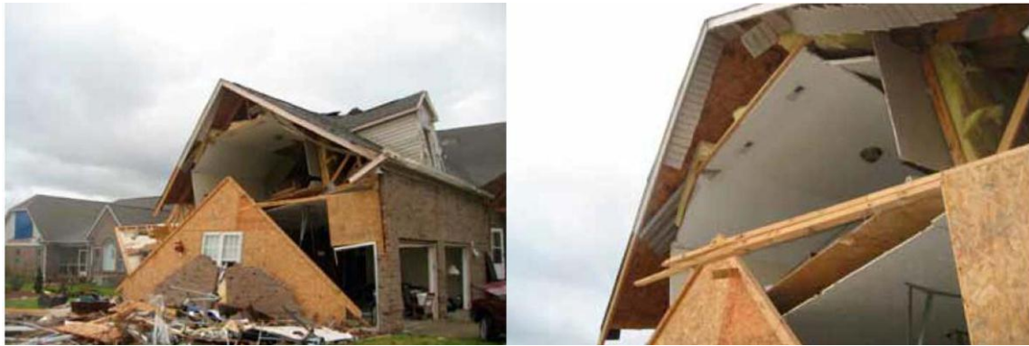
Şekil 4.63 Garajda oluşan basınç etkisinin duvarları yıkması [60]
