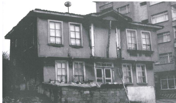
Şekil 4.25 Cumbası yıkılmış ahşap yapı [41]
