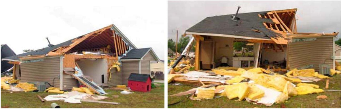
Şekil 4.50 Duvar – zemin bağlantısı ve yıkımı [60]
