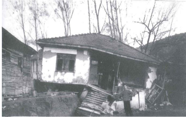
Şekil 4.14 Fay kırığına bağlı olarak ahşap yapıda oluşan hasar [41]
