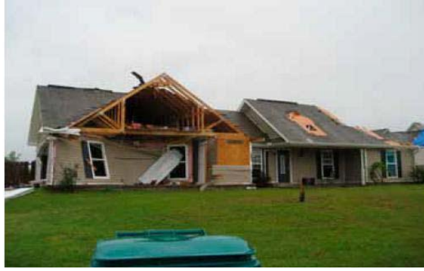
Şekil 4.74 Kalkan duvarının yıkılmasının yapıya olan etkisi [60]
