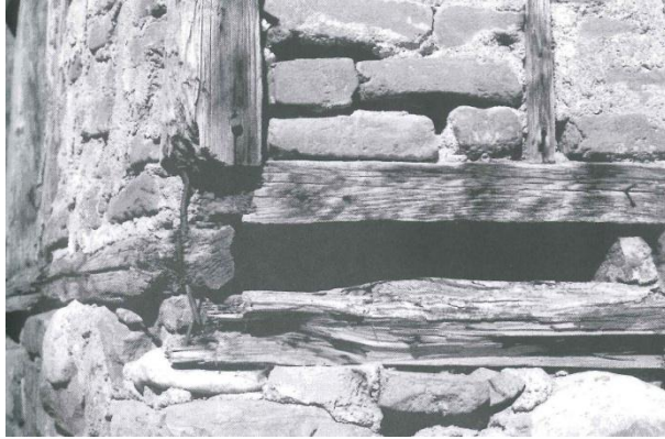
Şekil 4.33 Ahşabın niteliğini kaybetmesi nedeniyle bağlantı noktalarının zayıflaması [41]
