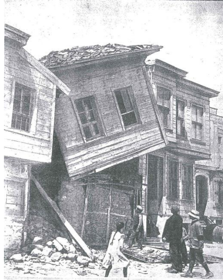
Şekil 4.19 Ahşap yapılarda görülen devrilmeler [41]
