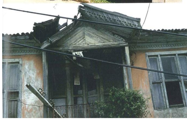
Şekil 4.27 Balkon saçağında hasar oluşmuş ahşap yapı [41]
