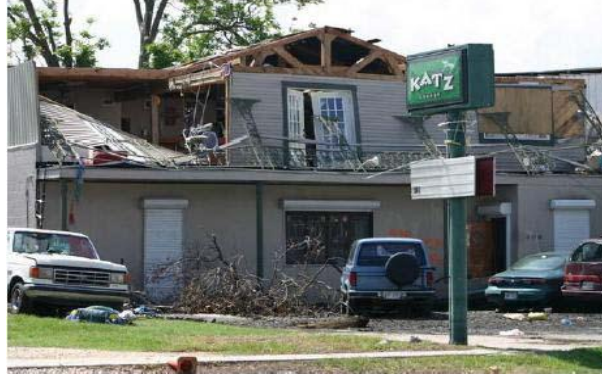
Şekil 4.60 Pencere kasalarında deformasyon [57]
