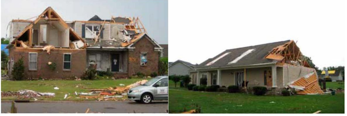
Şekil 4.73 Kalkan duvarlarında görülen hasarlar [60]
