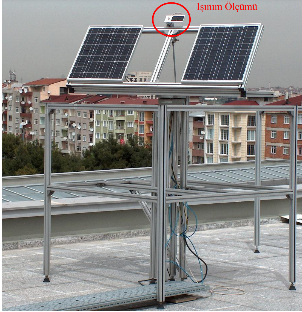
Şekil 4. 2 Hareketli platform ve PV paneller
