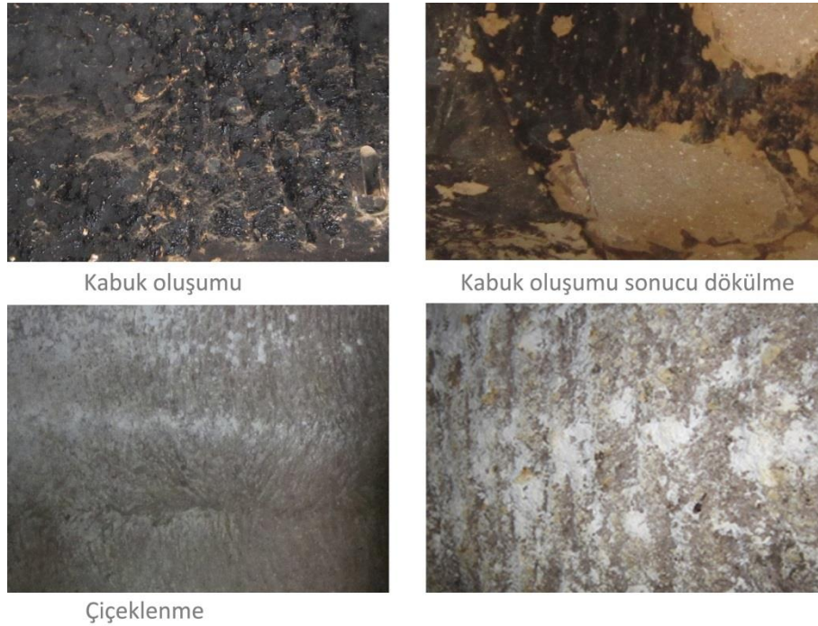
Şekil 4. 3 Kapadokya Bölgesi'nde taş hasar türleri: Kabuk oluşumu, kabuk oluşumu sonucu dökülme ve çiçeklenme
