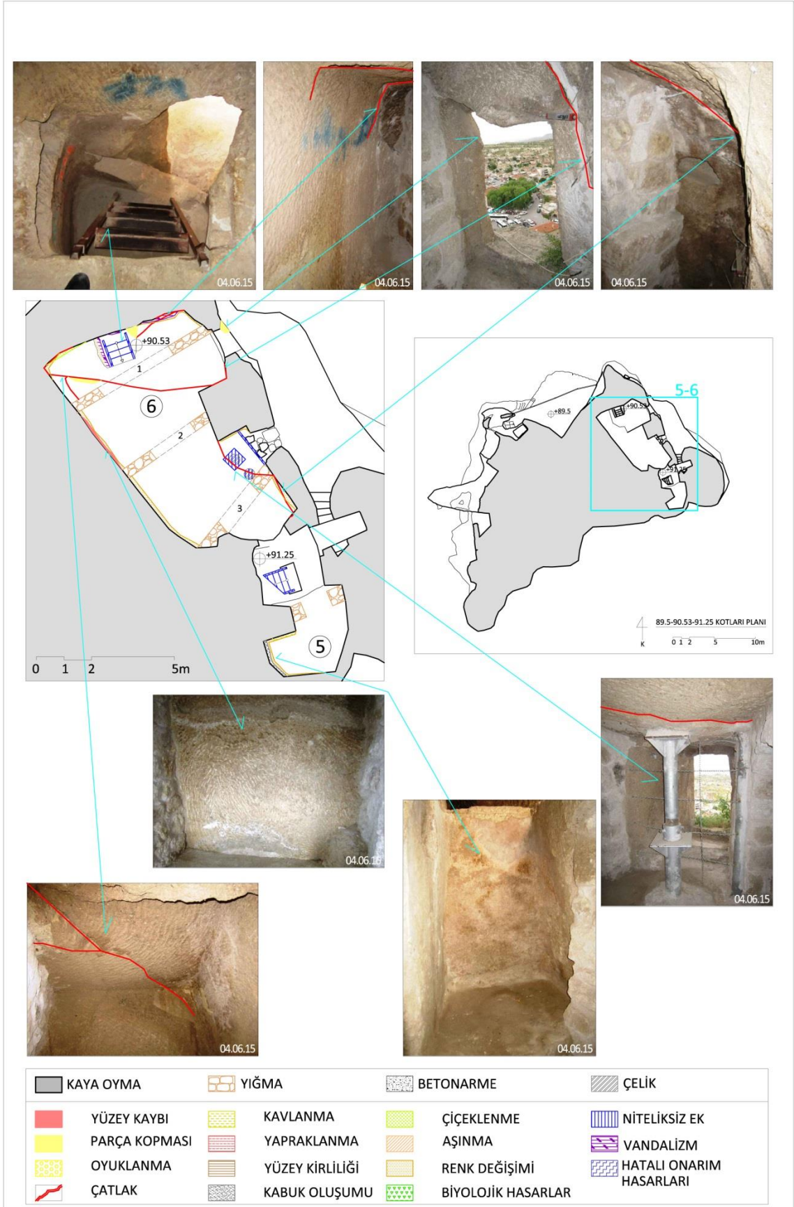
Şekil 4. 16 Ortahisar Kalesi 5 ve 6 no.lu mekânların hasarları
