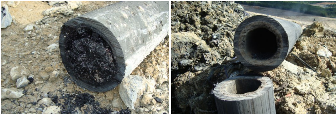
Şekil 2.3 Çeşitli malzemelerle tıkanmış dikey gaz toplama kuyusu
