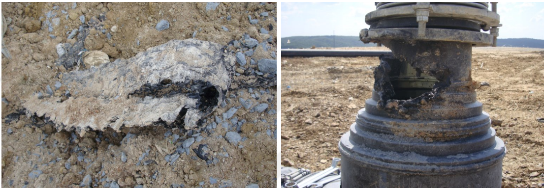
Şekil 2.4 Yangında hasar gören plastik borular
