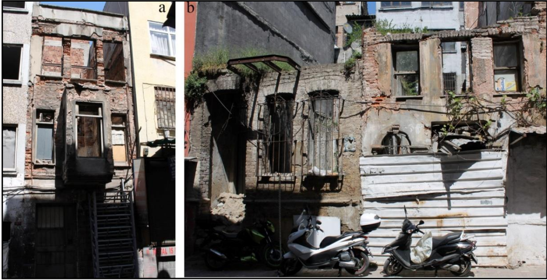
Şekil 3. 60 192 Ada 7 Parsel (a) ve 195 Ada 6-7 Parsellerde (b) yer alan yıkılmış tescilli kültür varlığı yapılar [Z.A.Ozan].
