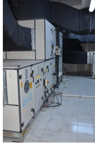
İklimlendirme Sistemi Ekipmanları
