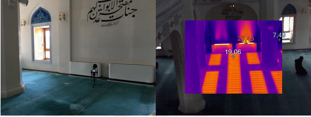
Şekil 3. 9 Duvar Önündeki Açık Döşeme Tipi Split Klimalar ve Yerden Isıtma Sistemi
