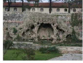
bf: Şale Kasrı bahçesinde yıkılan seraya ait grotto
