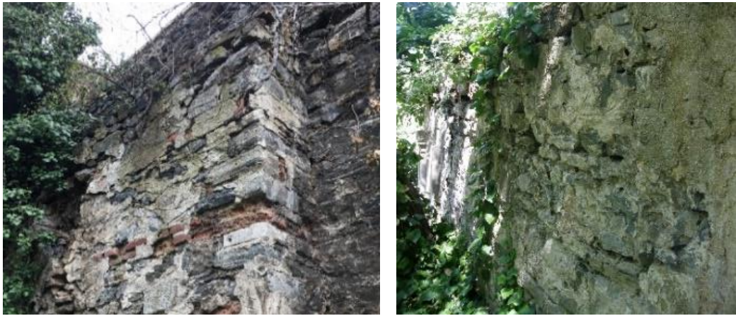
Şekil 3.44 Yıldız Sarayı Şehzade Köşkleri bahçesinde yüzey sıvası ve derz harcı bozulmuş bahçe duvarları
