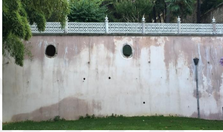
Şekil 3.43 Beylerbeyi Sarayı birinci set bahçesinin duvarındaki tuz birikimleri
