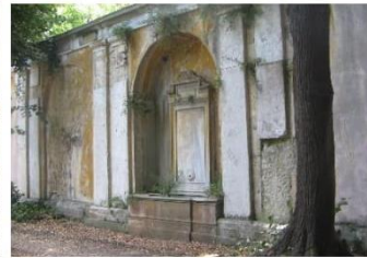
ad: 2005 yılında beşinci set bahçesine ait duvarda bulunan çeşmenin hali [61]
