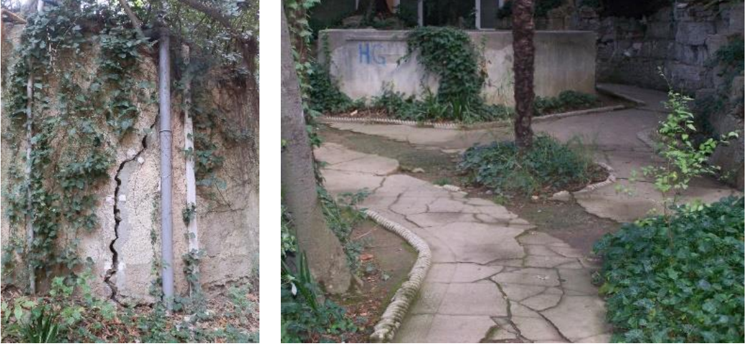
Şekil 3.49 Solda Yıldız Sarayı Şehzade Köşkleri bahçesinde ağaç kökünün gelişmesi sonucu tahribata uğramış bahçe duvarı, sağda aynı bahçede ağaç köklerinin gelişmesi sonucu zarar gören yer döşemesi
