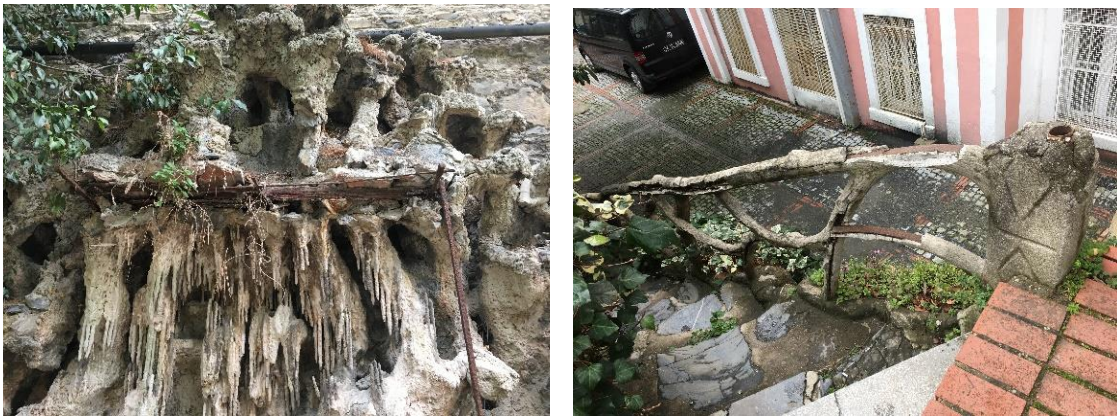
Şekil 3.52 Solda Yıldız Sarayı Şehzade Köşkleri bahçesinde bulunan grotto (grottonun demir iskeleti korozyona uğramış ve parça kayıpları oluşmuştur), sağda aynı bahçede iskeleti korozyona uğrayan ağaç dalı şeklinde bahçe korkuluğu
