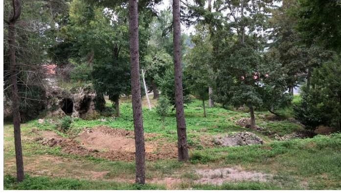
Şekil 3.36 Beykoz Kasrı bahçesinde harap durumda bulunan grotto ve grottaya ait bakımsız haldeki su yolları
