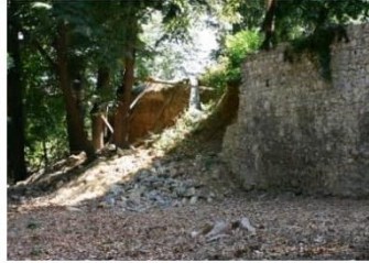
y: yıkılan set duvarı, 2006 yılı [61]
