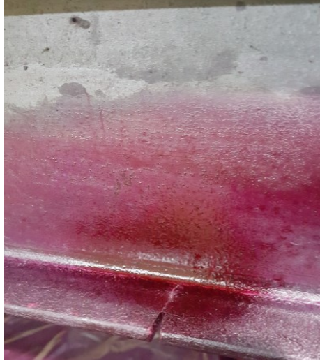
Şekil 4.9 Çatlak Oluşumu ve İlerlemesini Belirlemek İçin Kullanılan Sprey
