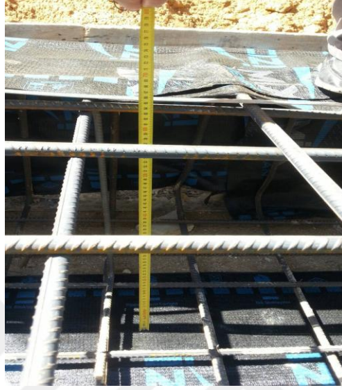
Şekil 4.33 Projeye aykırı temel kalınlığının tespiti
