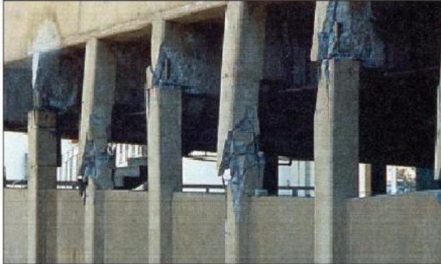
Şekil 4.24 Kolonları hasar görmüş bir yapı (California)
