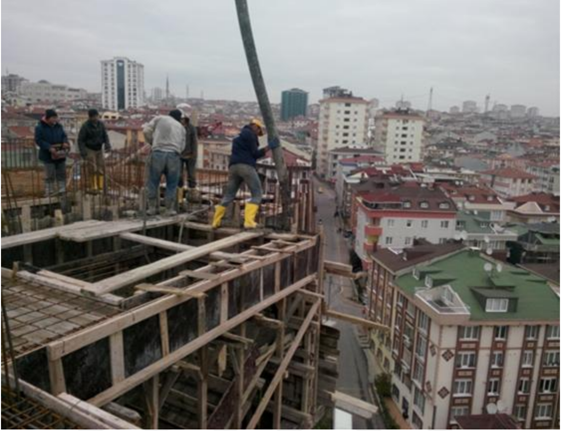
Şekil 3.2 İnşattaki kat betonu dökümünde işçilerin önlemleri olmadan çalışmaları
