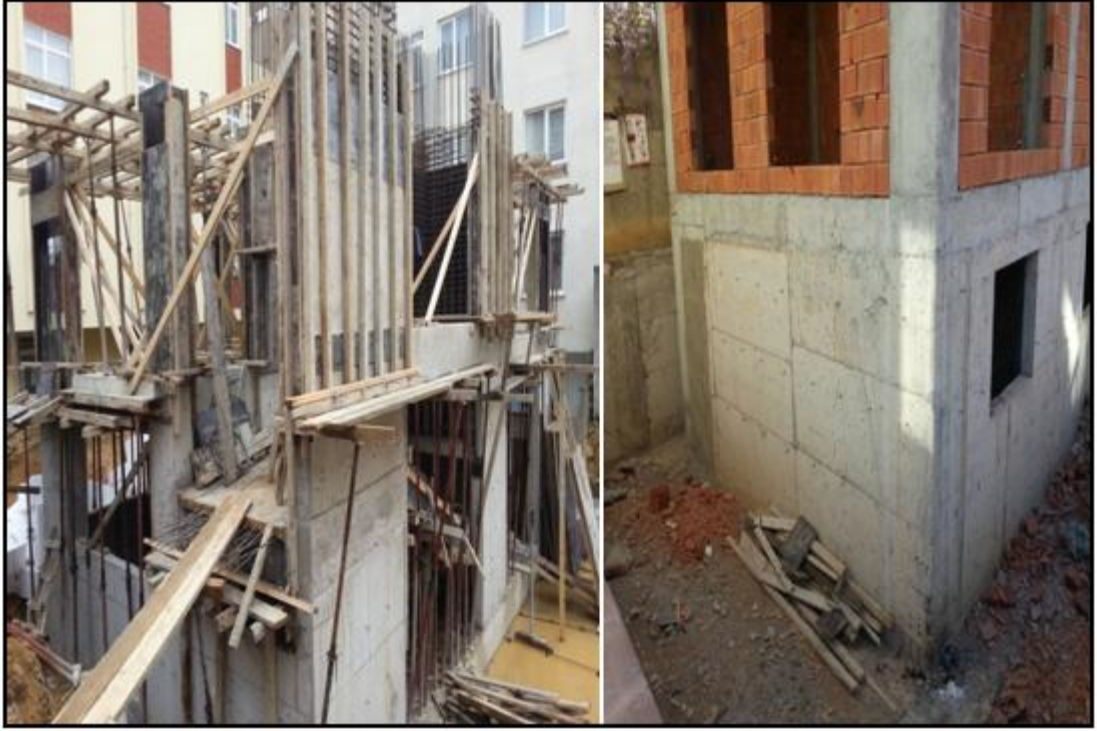
Şekil 4.41 Kısa kolon oluşumu
