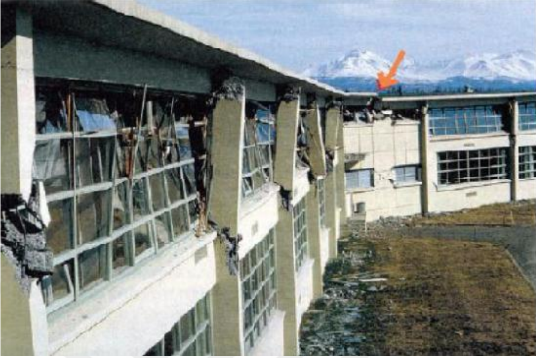
Şekil 4.17 Hasar görmüş bir lise binası (Alaska)
