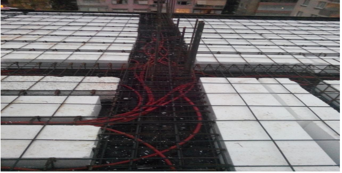
Őekil 4.53 Döřemelerdeki kiriř bořluğunda (yanlıř uygulama ile) geçen kablolar
