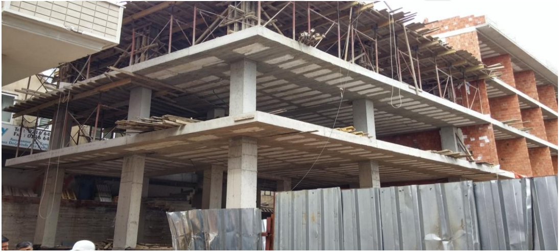
Şekil 4.44 İnşaattaki kalıp altı dikmelere yapılan müdahale
