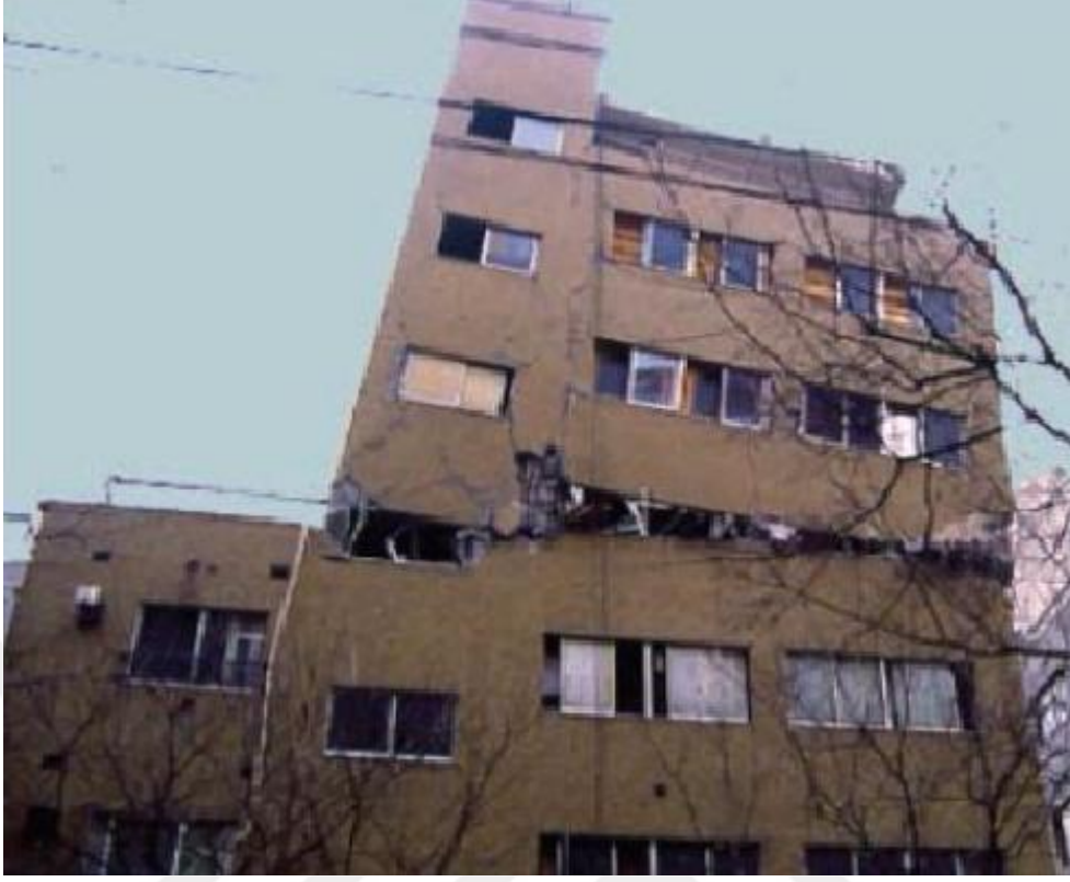
Şekil 4.25 Zayıf kat sebebiyle hasar görmüş bir yapı (Kobe-Japonya)
