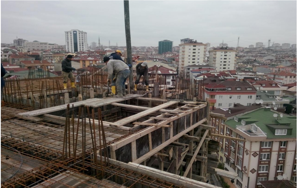
Şekil 3.1 İstanbul Ümraniye ilçesindeki bir şantiyede baretsiz çalışan işçiler
