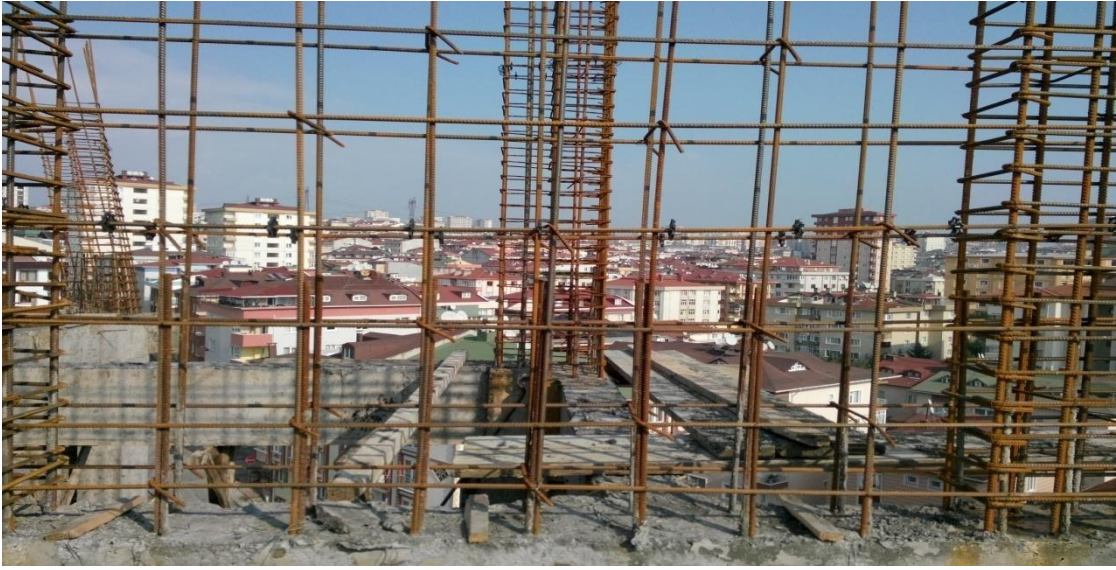
Şekil 4.45 Betonarme perdelerde çirozların eksik konması
