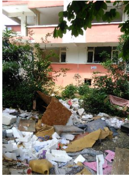
Şekil 3. 8 Riskli binanın yıkımı öncesi oluşturduğu görüntü kirliliği
