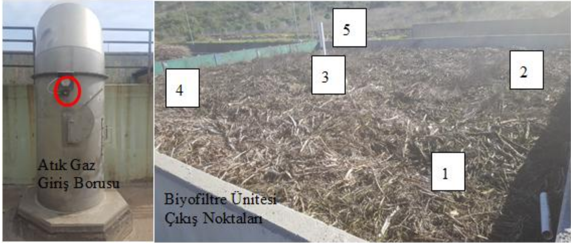
Şekil 4.4 Biyofiltre ünitesinde TOK ölçümü yapılan atık gaz giriş ve çıkış noktalarının genel görünümü
